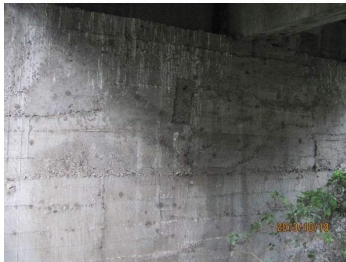
Figura 44. Terminados de mala calidad en Estribos y Pilas
