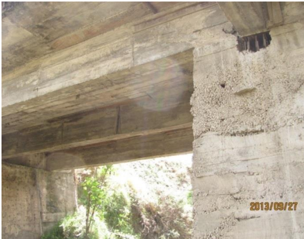
Figura 42. Mala inspección y Falta de Mantenimiento
