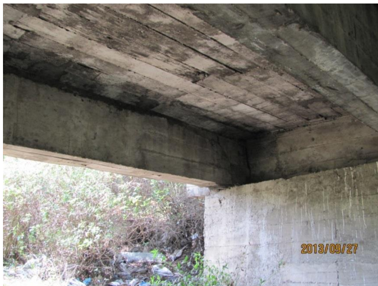
Figura 20. Falla Cortante en Viga exterior izquierda
