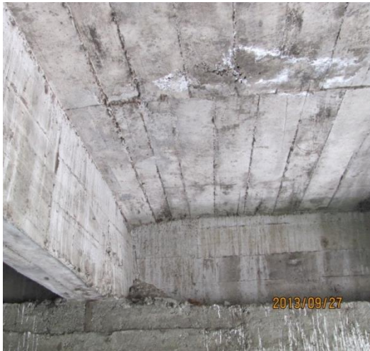
Figura 38. Carbonatación en losa
