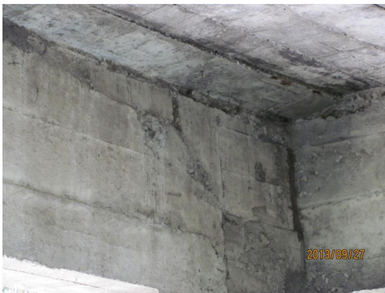
Figura 21. Falla Cortante en Viga 1
