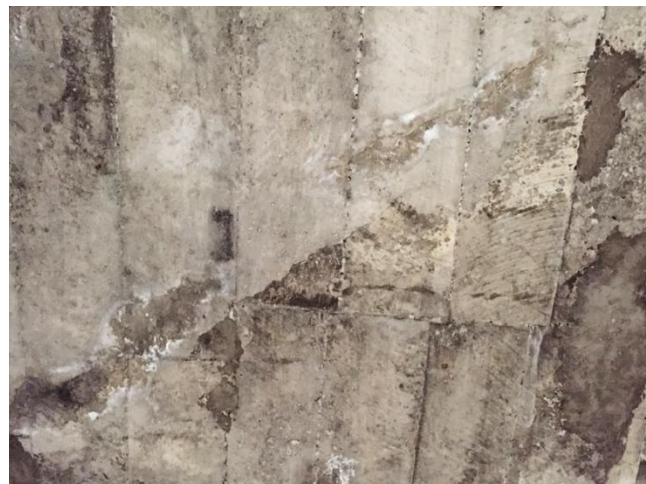
Figura 15. Agrietamiento no continuo en losa entre Pila B y C
