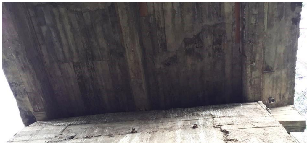
Figura 16. Agrietamiento en losa entre Pila C y Estribo D
