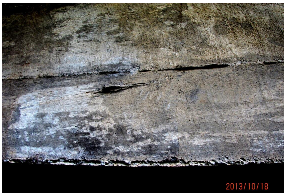
Figura 18. Grietas en viga 1
