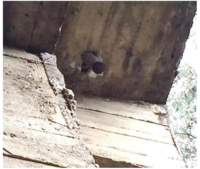
Figura 47. Diseño precario de Alcantarillado
