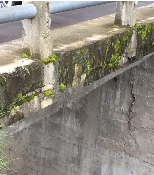
Figura 46. Terminados de mala calidad en Vigas y Bordillos
