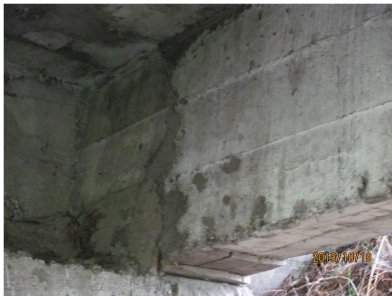
Figura 22. Grieta Recubierta en Viga 1 Lado Norte
