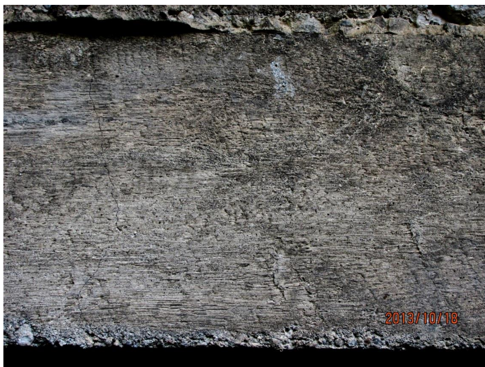
Figura 17. Grietas en viga 1
