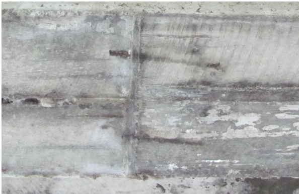
Figura 40. Exposición de Acero en Vigas
