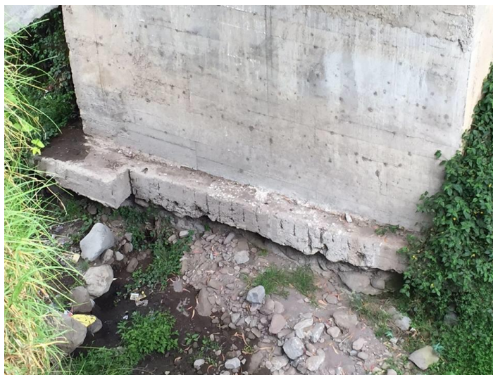
Figura 32. Socavación en Pila C
