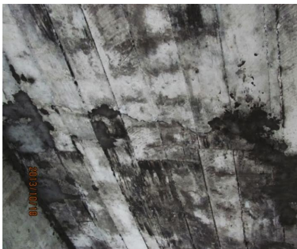
Figura 14. Fisura en losa del tablero
