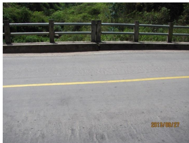
Figura 31. Desalineamiento del Tablero sobre Pila C
