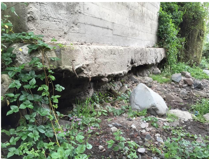
Figura 35. Socavación en Pila C
