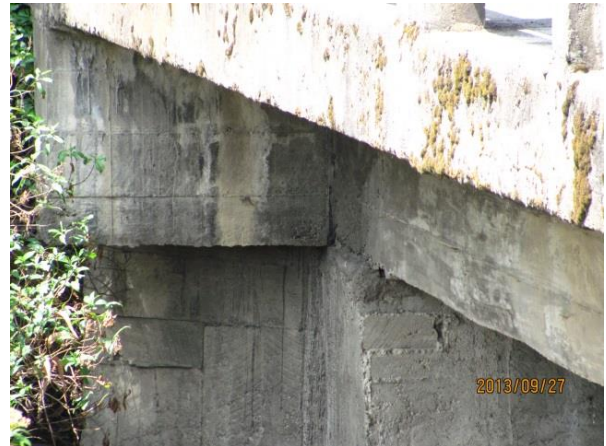
Figura 39. Carbonatación en Vigas
