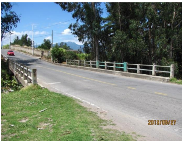
Figura 30. Desalineamiento en el Tablero
