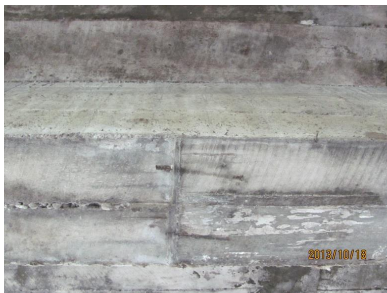
Figura 23. Coquero en Vigas
