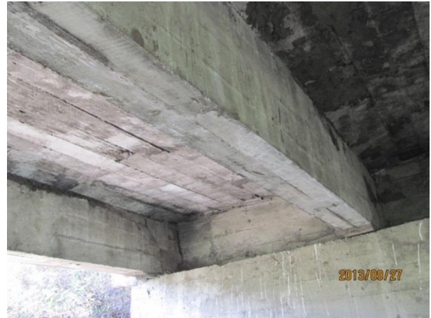
Figura 43. Encofrado de Baja Calidad
