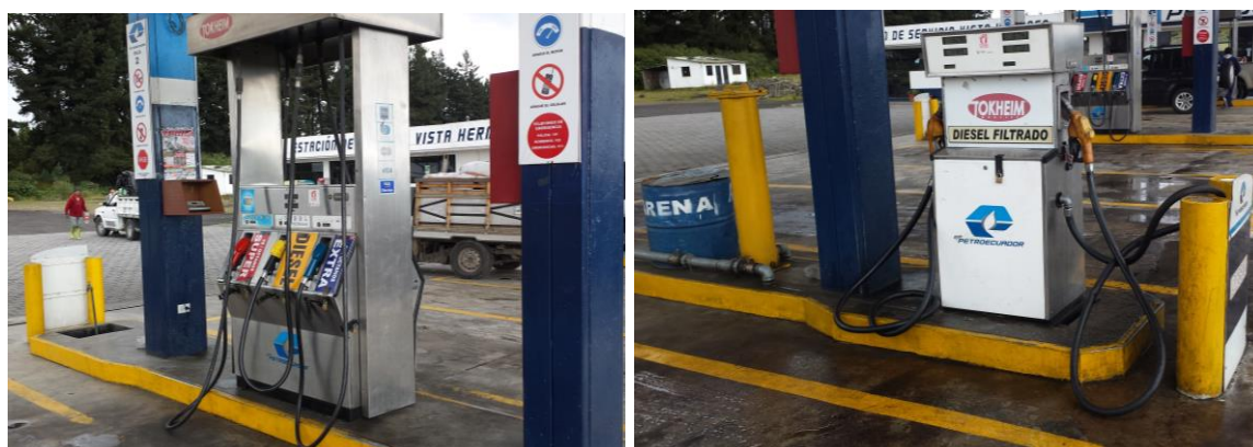
Ilustración 6: Surtidor de combustible
