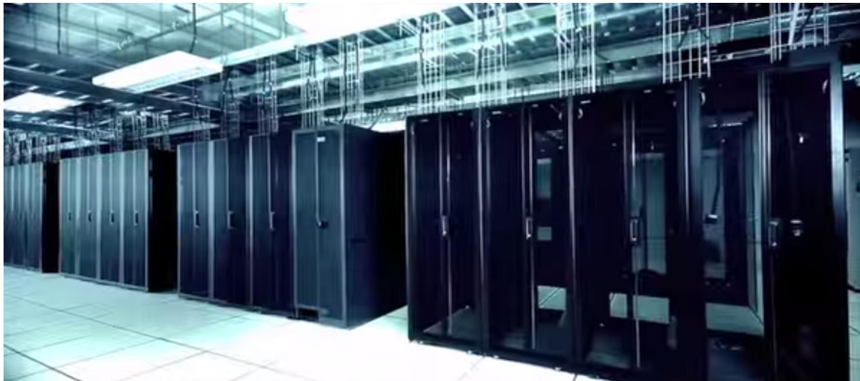
Ilustración 2. Vista interna del Cloud Center de Telconet (Telconet S.A., 2015)
