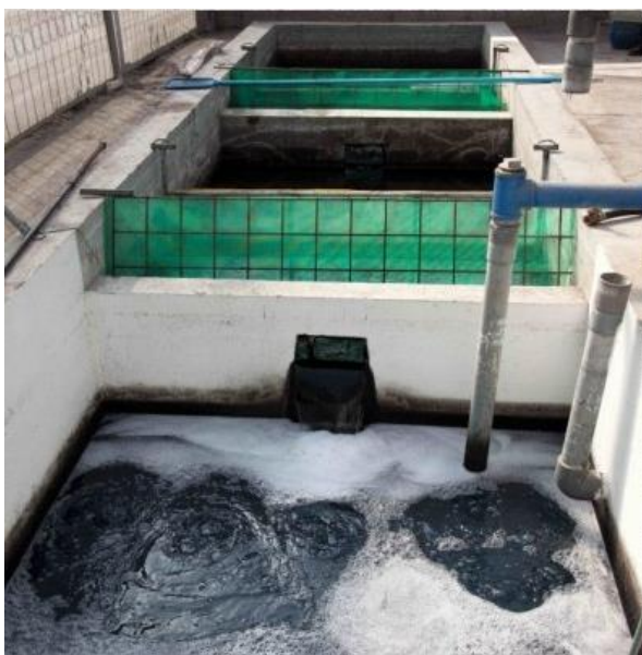
Imagen 1: Tanques de homogenización de los efluentes de salida de TSJ
