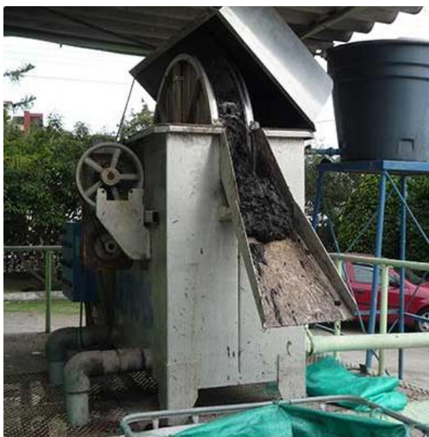
Imagen 2: Filtro retenedor de pelos proveniente de las aguas residuales del proceso de remojo y pelambre de TSJ
