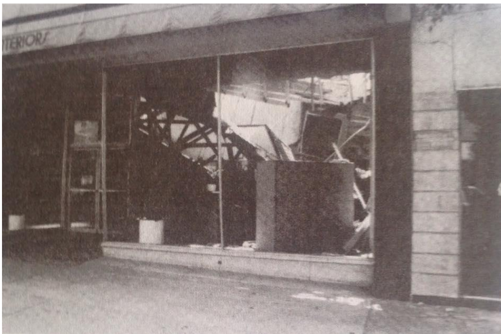
Figura 6-3 Colapso de cerchas estructurales que no se encontraban correctamente empotradas a la pared de mampostería. La edificación fue marcada como Insegura.
