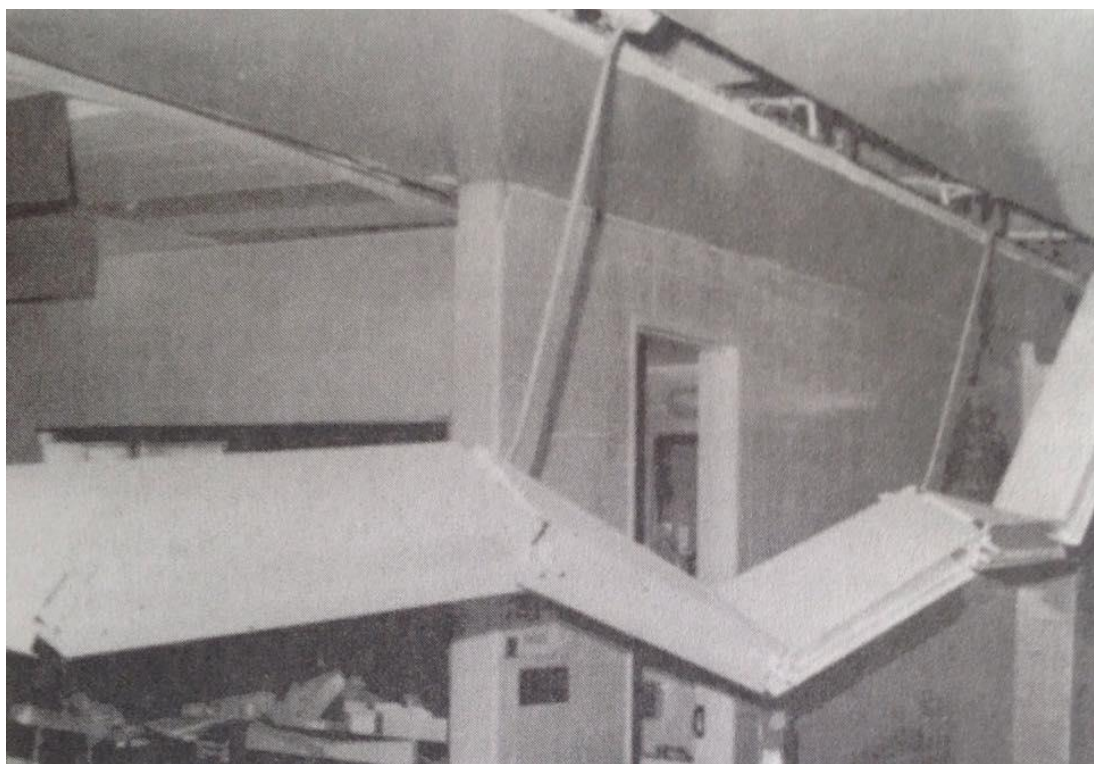
Figura 12-5 Iluminación fluorescente rota. Marcar Uso Restringido y barricar el área insegura.
