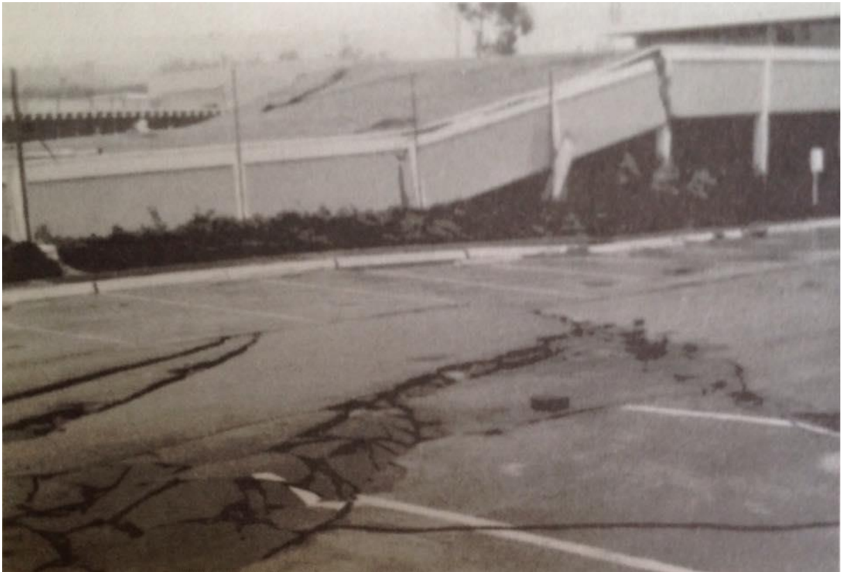
Figura 11-7 Daños estructurales en el Valley Juvenile provocado por el movimiento lateral del suelo. Marcar Inseguro
