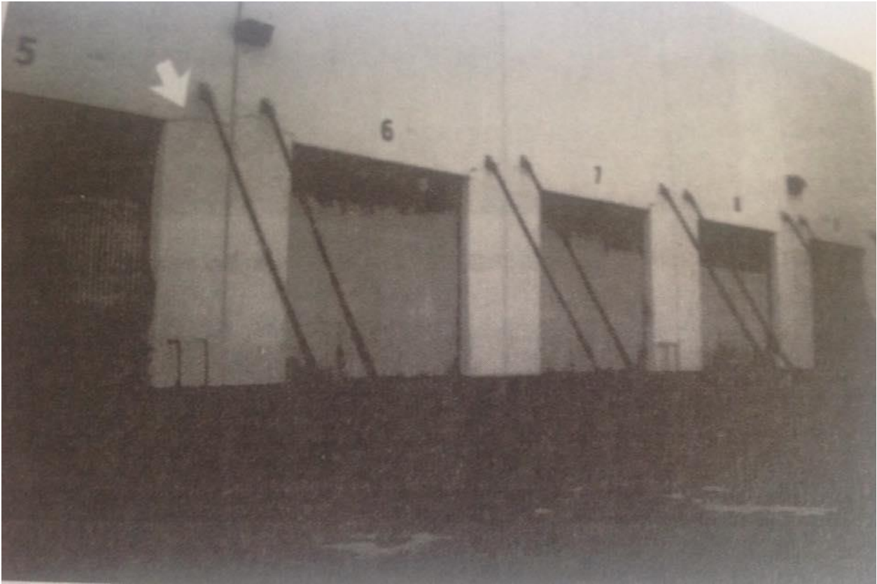
Figura 7-7 Investigadores estructurales calificados tendrán que examinar y evaluar las grietas de los paneles modulares, que para el caso de la figura consta en luces grandes distancias.
