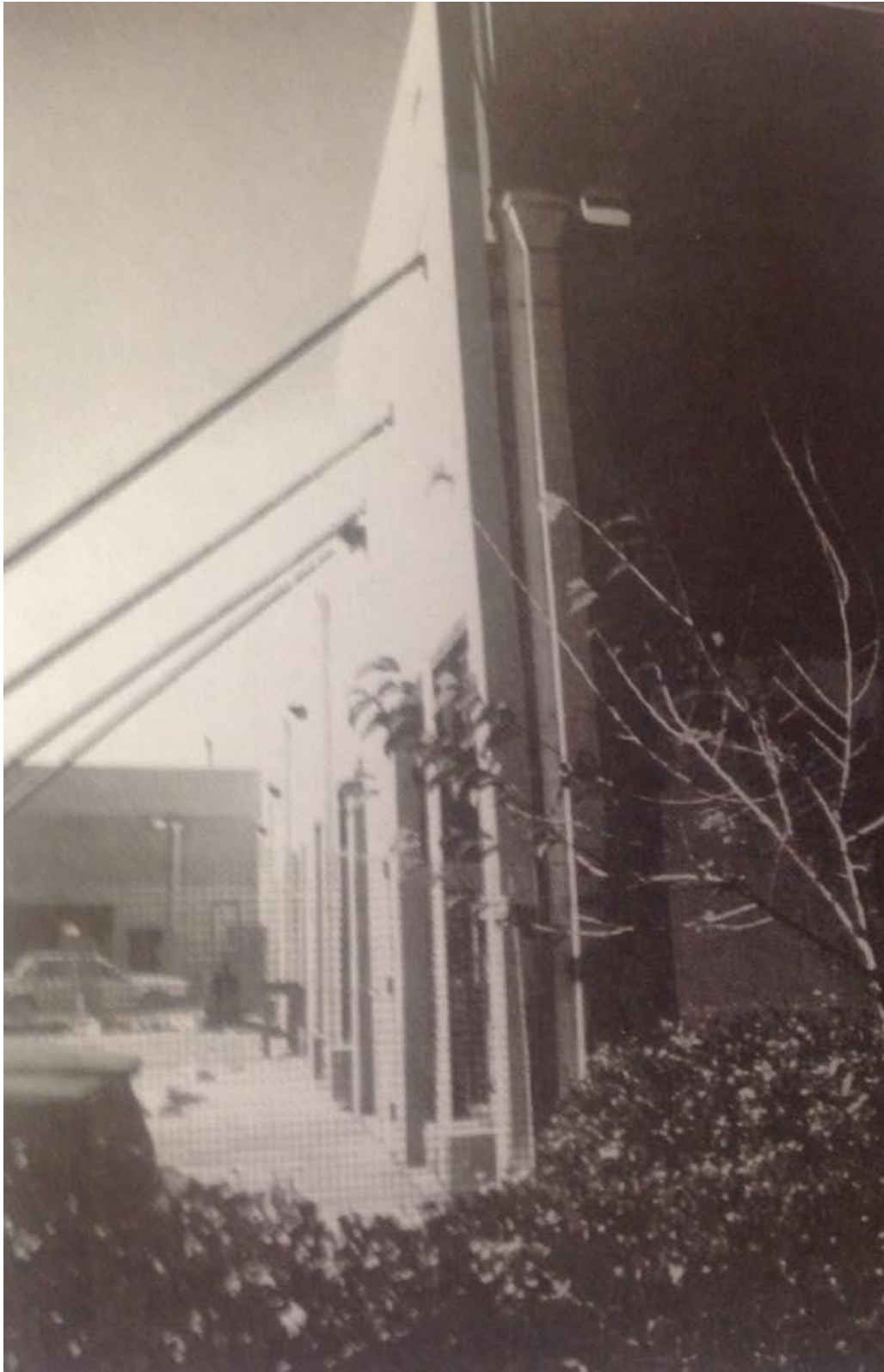
Figura 7-6 Una estructura modular prefabricada recién construida sufre de separación entre sus paredes. Esta separación e inclinación se ha visto temporalmente controlada con un sistema de apuntalamiento.
