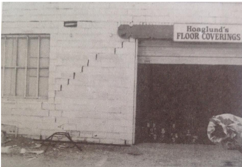
Figura 6-5 Pared de mampostería sin refuerzo estructural con fisuras en forma de gradas.
