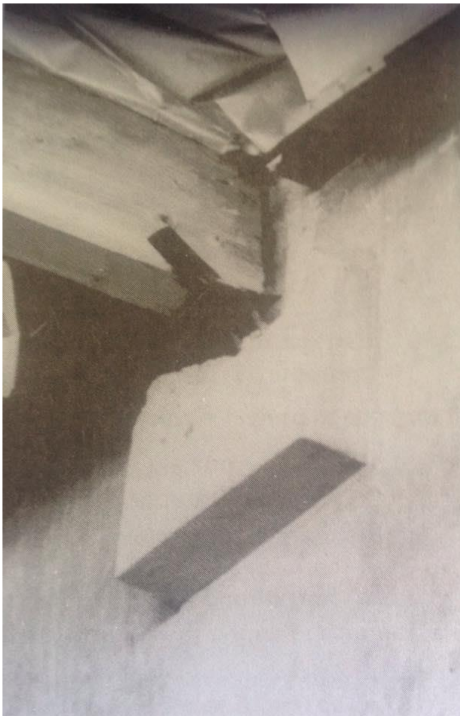
Figura 7-3 Viga de madera con daños cerca del apoyo vertical, su resistencia a cargas verticales quedó seriamente disminuida. Marcar Insegura.
