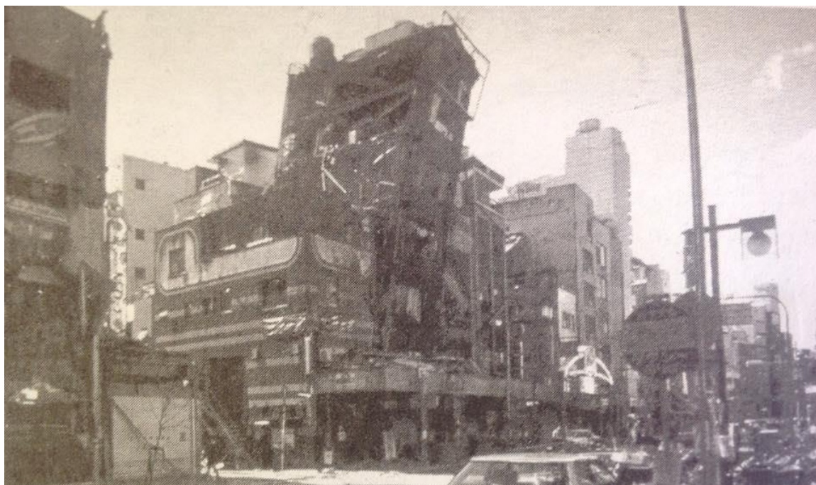
Figura D-3 Esta edificación de oficinas en Kobe, Japón es considerada Insegura e inestable. Es visible que la estructura puede colapsar en cualquier instante o aún más en las réplicas sísmicas. El ingreso no es permitido.
