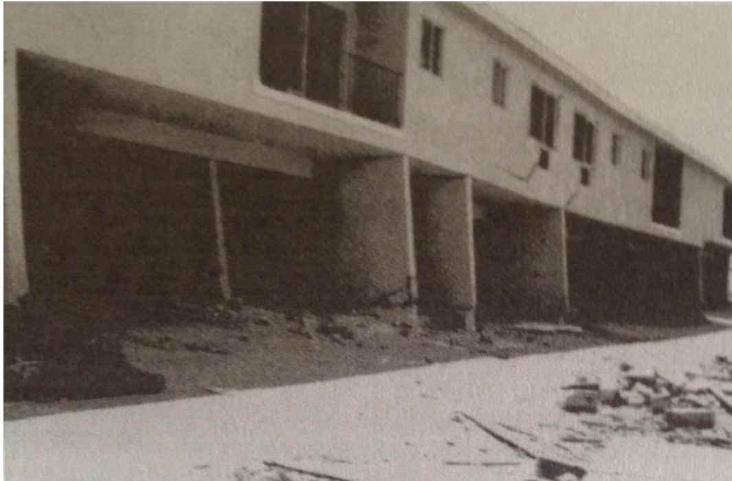
Figura 5-6 Edificación de departamentos con serios daños estructurales. Marcar Inseguro
