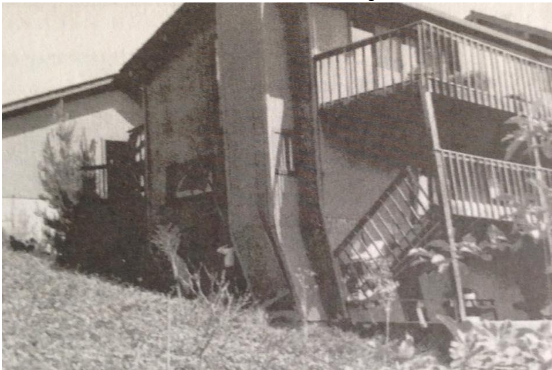
Figura 5-4 Edificación que se encuentra en un terreno inclinado y en donde se encuentran daños estructurales en las paredes y balcones. Marcar Inseguro.
