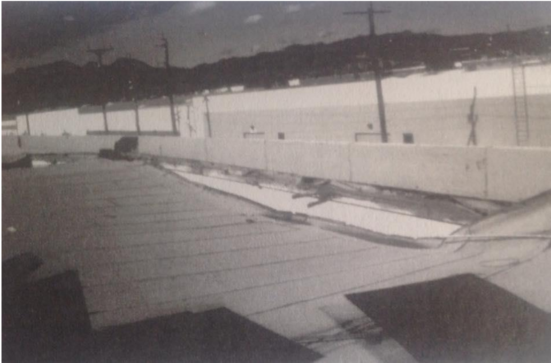
Figura 7-4 El techo de esta estructura modular prefabricada se ha separado de las paredes y se encuentra al borde del colapso. Marcar Inseguro
