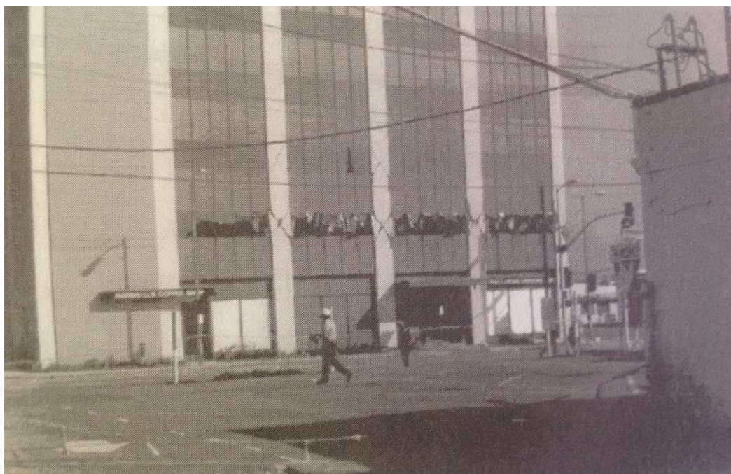
Figura D-5. La edificación de hormigón no dúctil de seis pisos tiene severos daños en las columnas del segundo piso. La estructura es considerada Insegura e inestable tomando en cuenta que las columnas pueden ceder en cualquier momento. El ingreso no es permitido.
