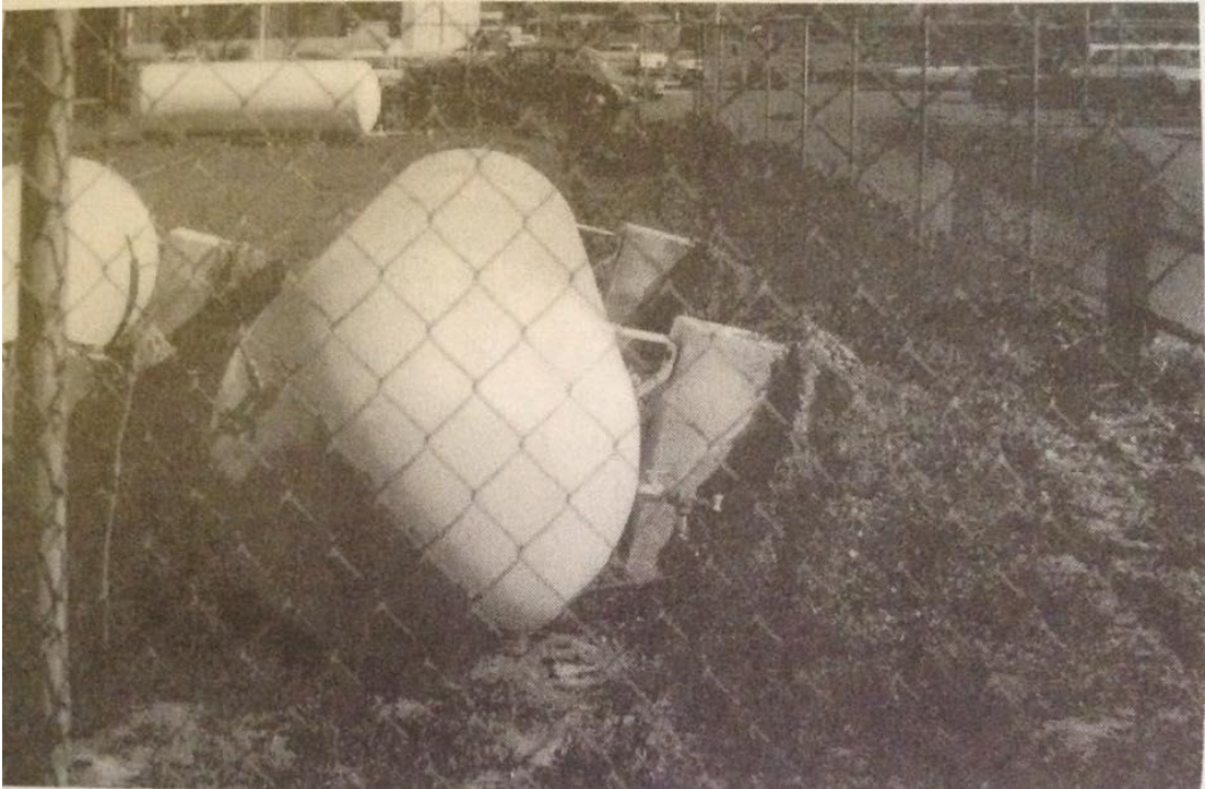
Condición 6: Otras amenazas (El. Tanque de Propano fuera de su base). Cercar el área insegura.
