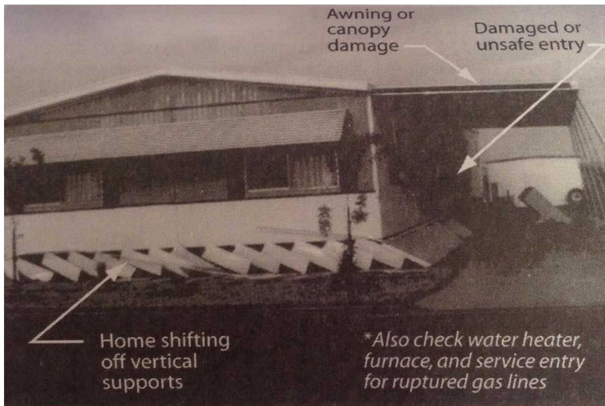
Figura 10-1 Puntos de inspección para casas móviles. Marcar Inseguro a las casas con similares afectaciones.
