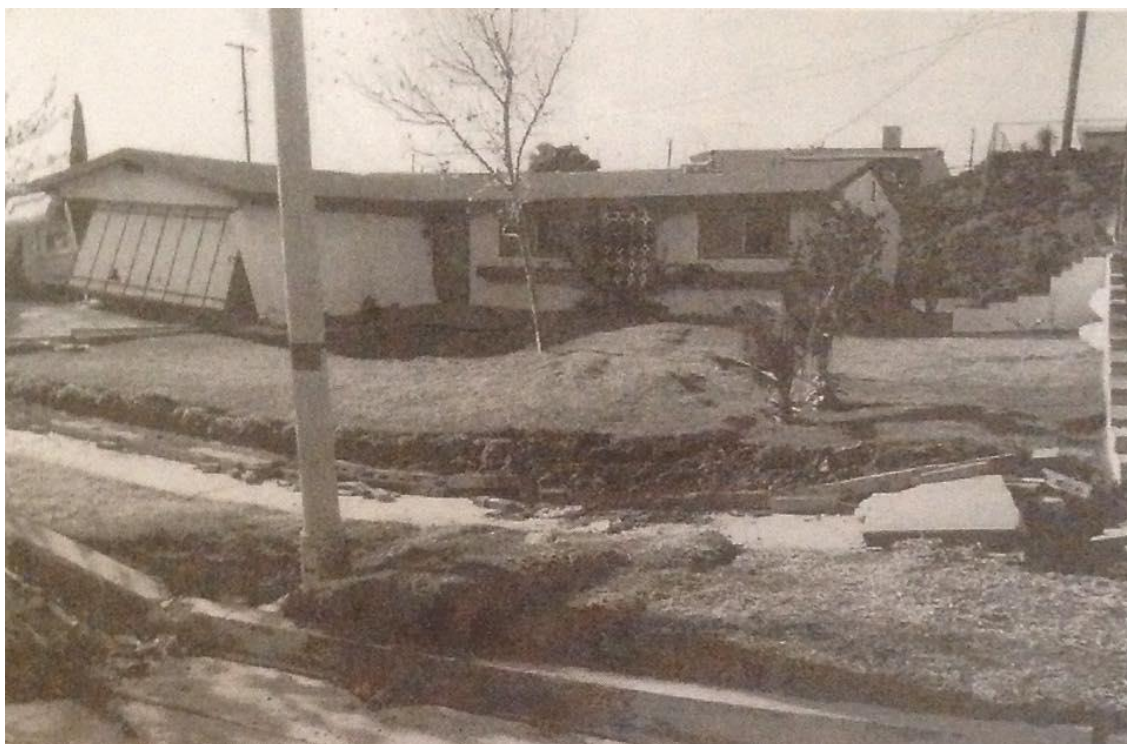
Condición 5: Daño estructural producido por movimiento del suelo o cimentación afectada. Señalizar Inseguro.
