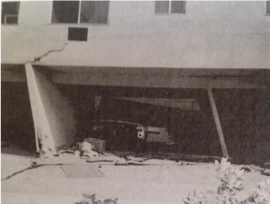
Figura 5-7 Otra vista de los apartamentos mostrados en la Figura 5-6, existen severos daños estructurales y una inclinación de la edificación.
