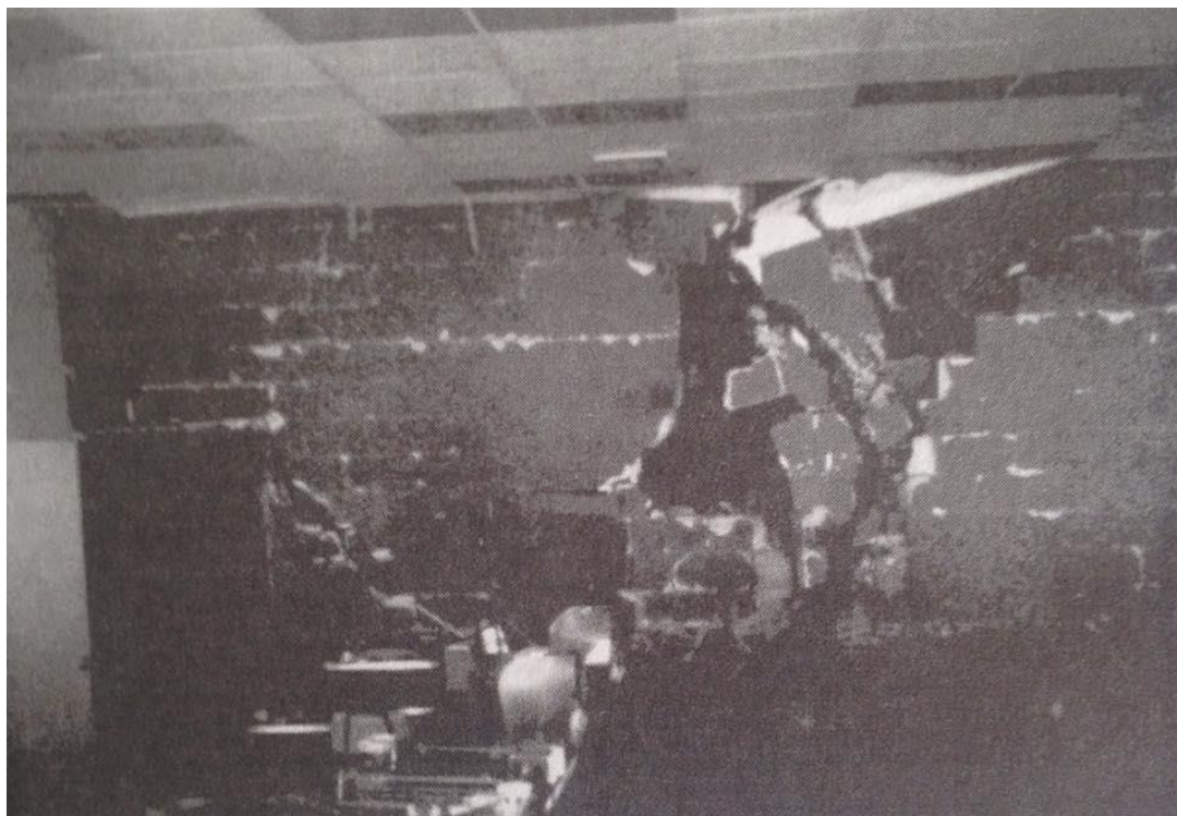
Figura 12-6 Severos daños en pared interior de mampostería sin refuerzo estructural. Marcar como Uso Restringido y barricar el área insegura
