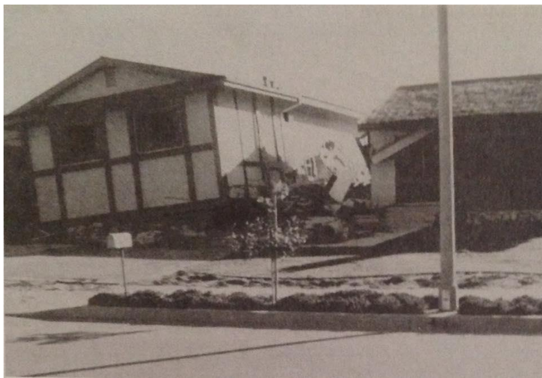
Condición 1: Colapso, Colapso Parcial o cimentación levantada. Señalizar Inseguro.
