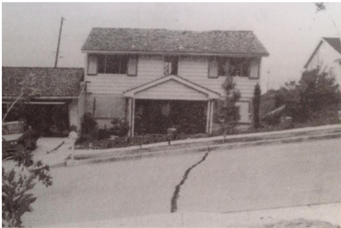
Figura 11-4 Calle y casa con serios daños provocados por el desplazamiento de suelos ocurrido en el terremoto de San Fernando. Marcar Inseguro.
