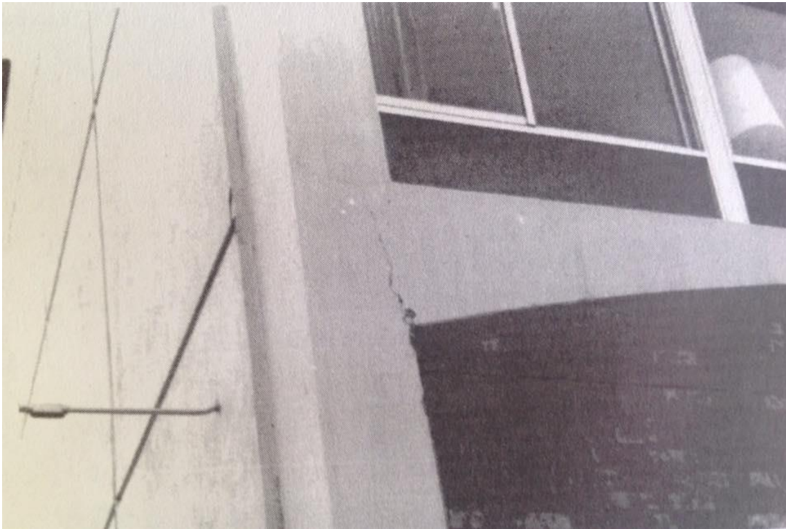
Figura E-6 Fisuras en viga del segundo piso, Ejemplo 2.
