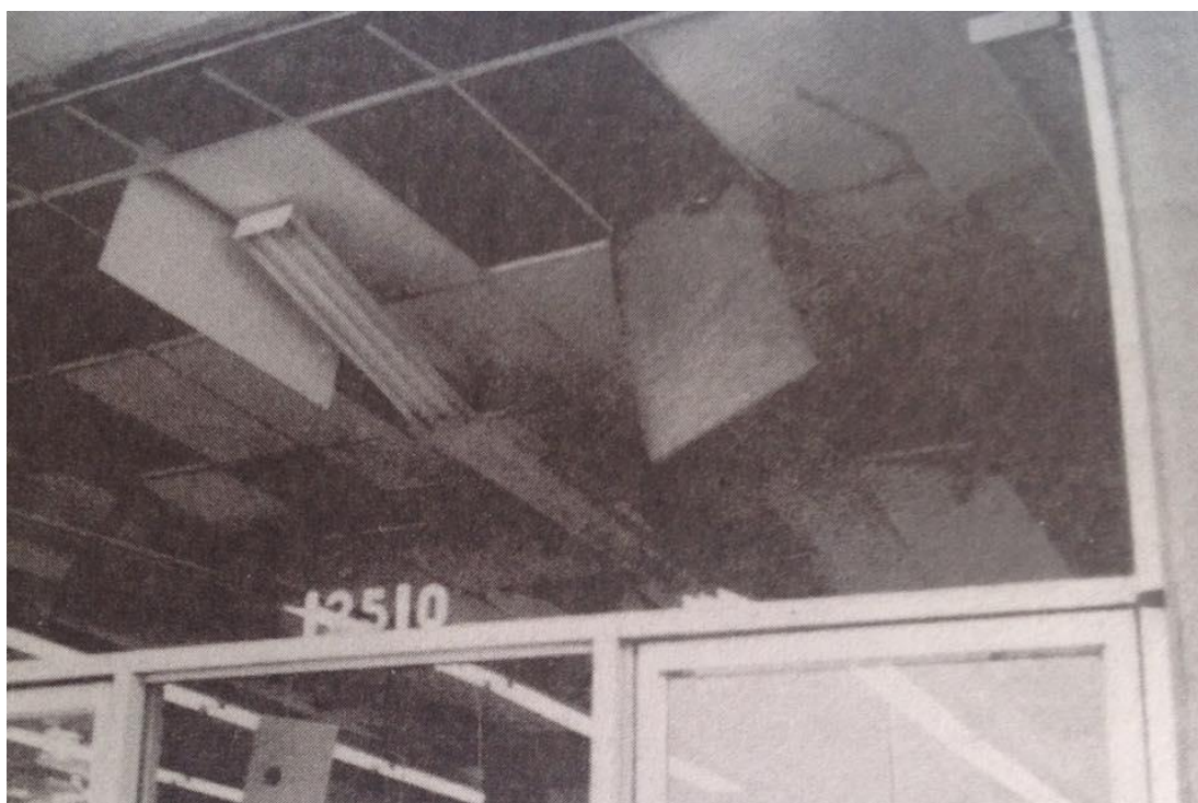
Figura 12-4 Cielo falso e iluminación afectada por el sismo. Marcar como Uso Restringido y barricar el área insegura.
