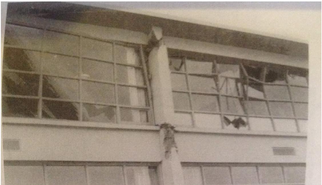
Condición 3: Daños severos en elementos estructurales importantes, grietas grandes en paredes u otros daños severos. Señalizar Inseguro.
