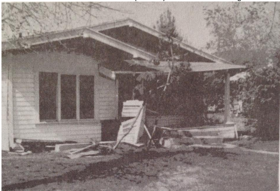
Figura 5-4 Edificación que se encuentra en un terreno inclinado y en donde se encuentran daños estructurales en las paredes y balcones. Marcar Inseguro.
