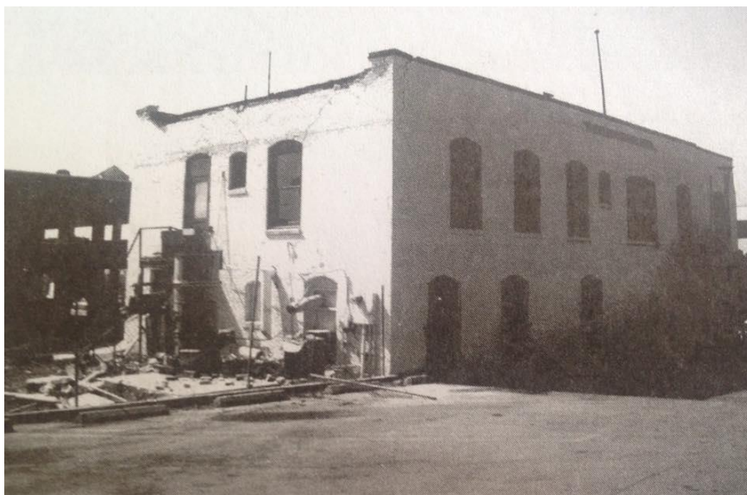
Figura 6-6 Edificación de mampostería sin refuerzo estructural con serios daños. Además de las obvias afectaciones visibles en las paredes exteriores de la estructura, en el interior sus paredes se encontraban gravemente afectadas, finalmente la edificación fue marcada como Insegura.
