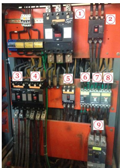
Figura 3: Panel de distribución 630kVA
