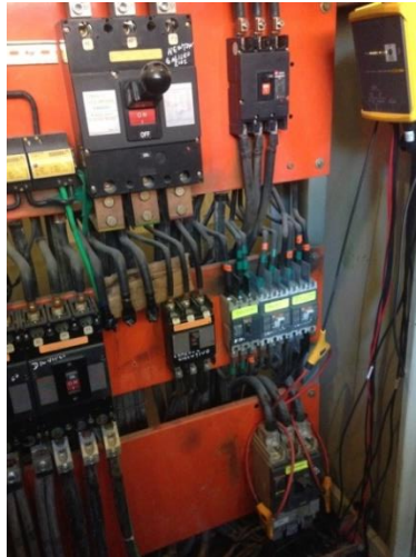
Figura 7: Conexión del analizador industrial de potencia en el área de cuartos fríos
