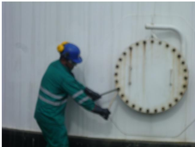
Figura No. 28 Colocación o retiros de pernos en manhole Fuente: Elaboración Propia
