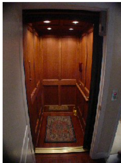
[Figura 23. Referencia ascensor]
