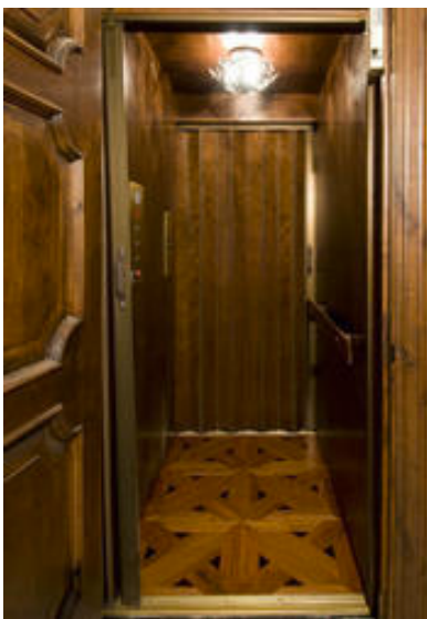
[Figura 22. Referencia ascensor]
