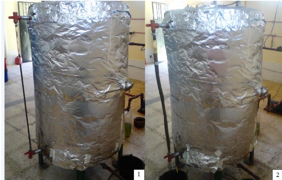
Figura 4.31. Biodigestor con medidor de nivel antes y después de cambio de manguera
