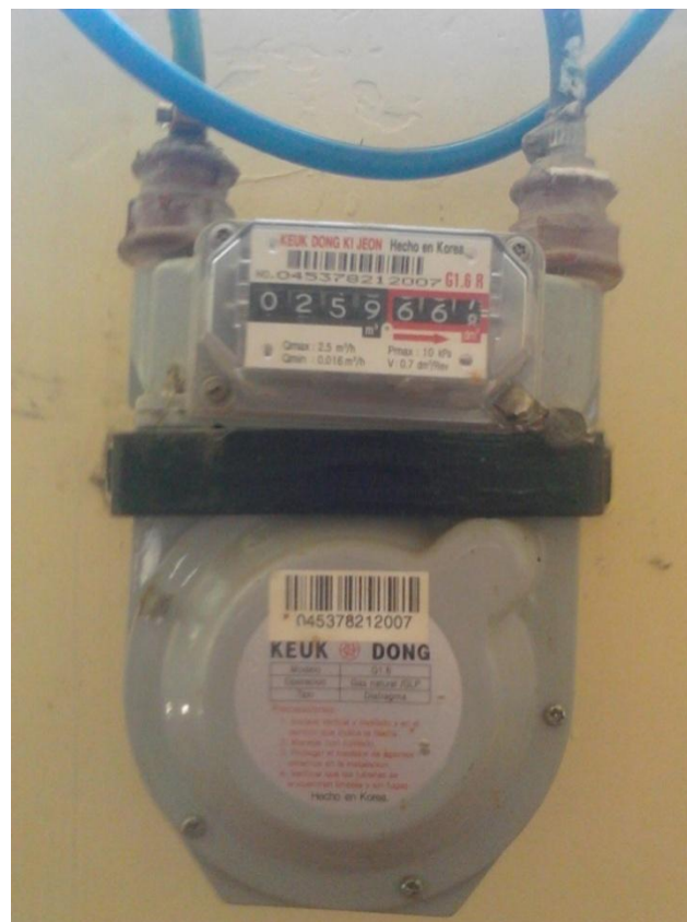
Figura 3.13. Contador de gas marca Keuk Dong
