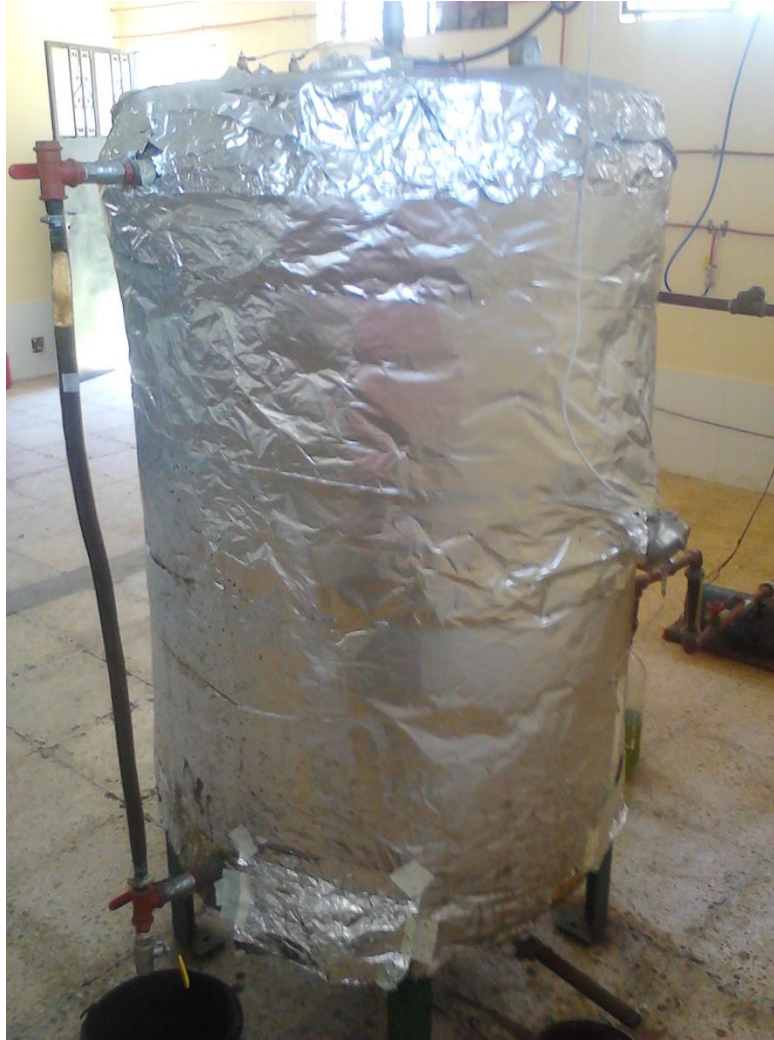
Figura 3.2. Reactor para digestión anaerobia del LaDEA
