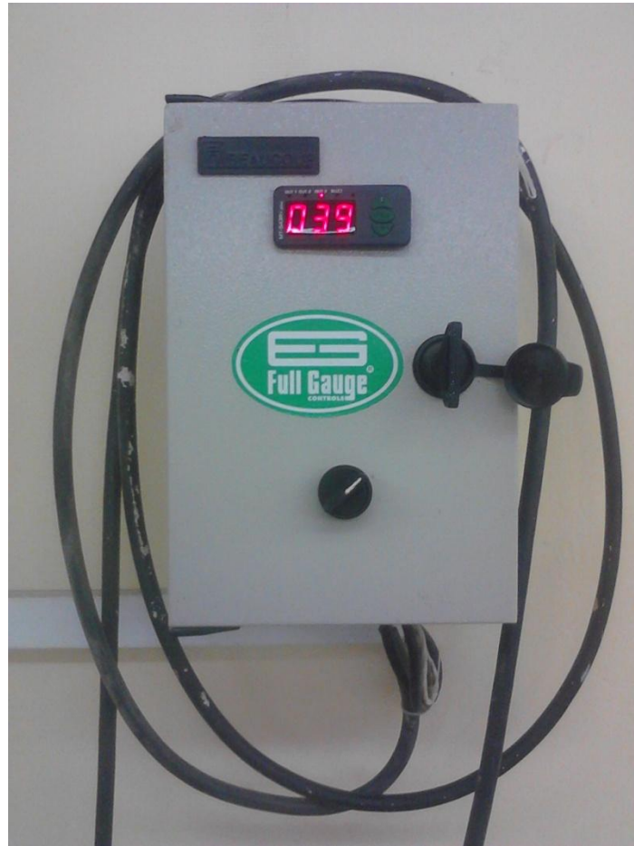
Figura 3.11. Controlador automático de temperatura y nivel
