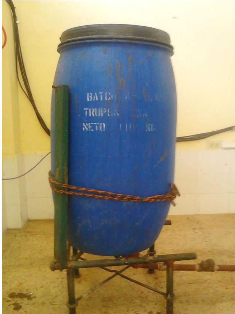
Figura 3.8. Tanque de alimentación
