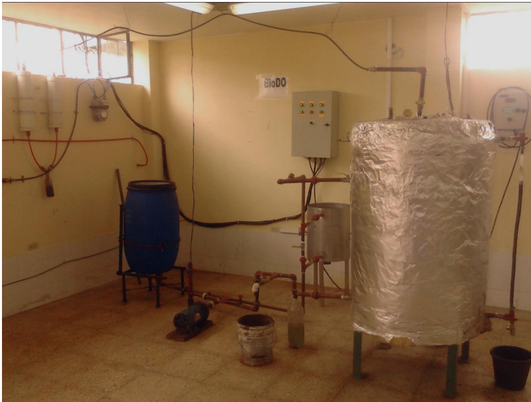
Figura 3.1. Biodigestor a escala piloto del LaDEA
