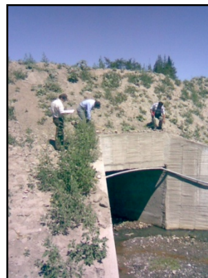
Fotografía 3.2 Alas de alcantarillas
