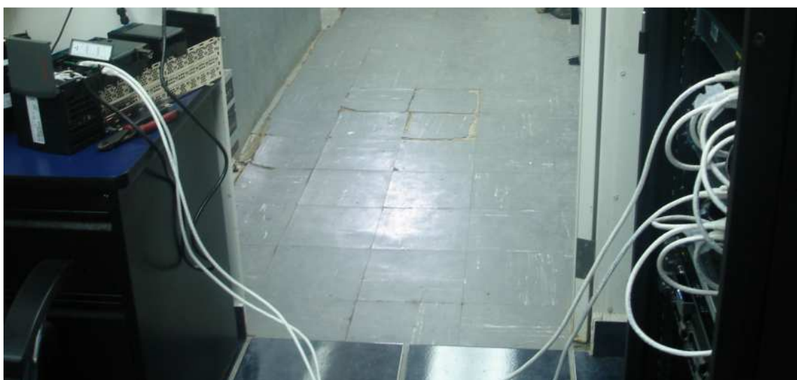
Gráfico 24: PLC conectado con los servidores para la prueba de actualización
