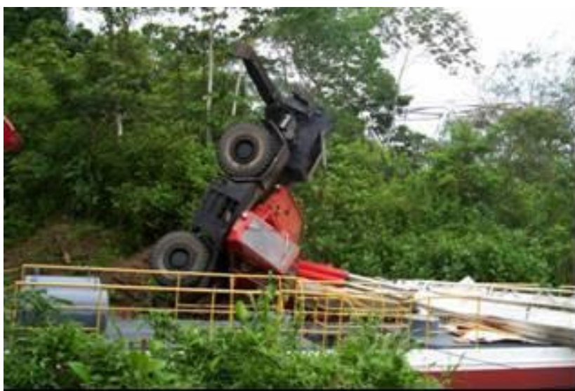
Figura 18. Volteo de grúa por sobre carga.
