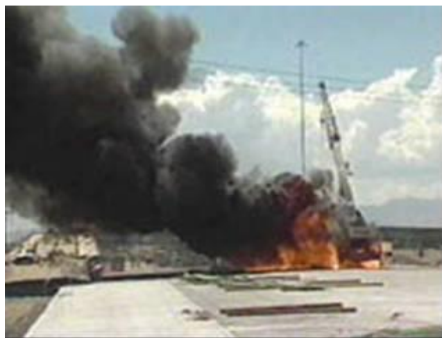
Figura 19. Incendio por contacto eléctrico.
