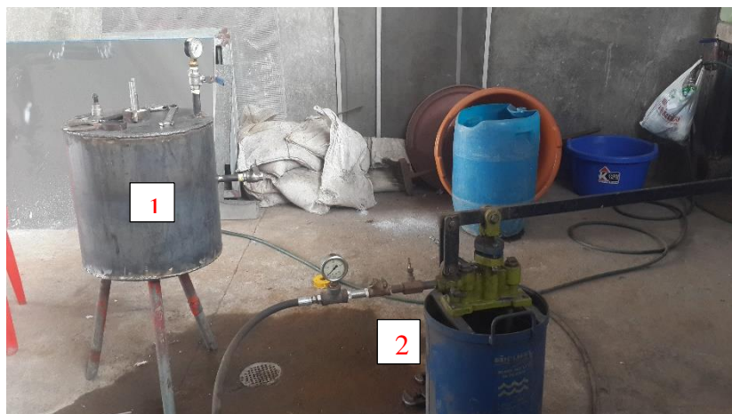
Figura 21: Instalación adecuada de máquina para pruebas en sellos preno estopa
