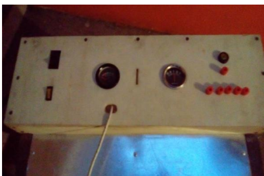
Figura 34 Tablero de mando
