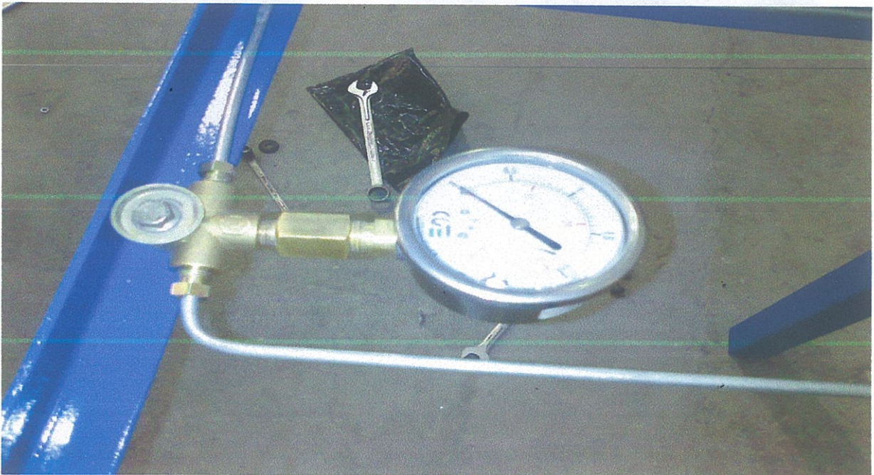
FIGURA 4.10: Cañerías para el fluido hidráulico perfectamente trazadas a la medida junto con los manómetros de presión.
