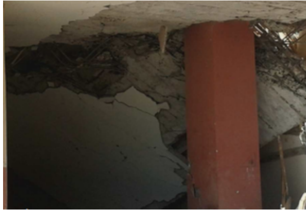
Figura 66. Punzonamiento de columna (GEER, 2016)
