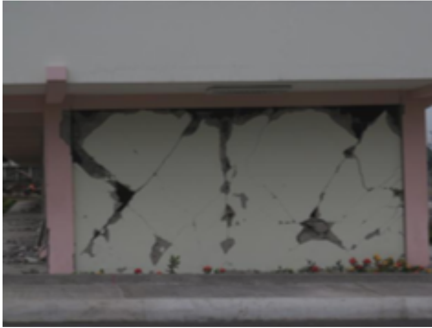
Figura 67. Mampostería daños post evento sísmico (Fuente: GEER, 2016)
