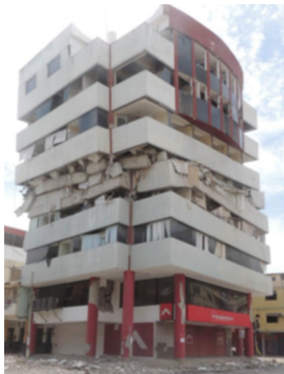
Figura 69. Columna corta en pisos (cuarto y quinto) (Fuente: GEER, 2016)
