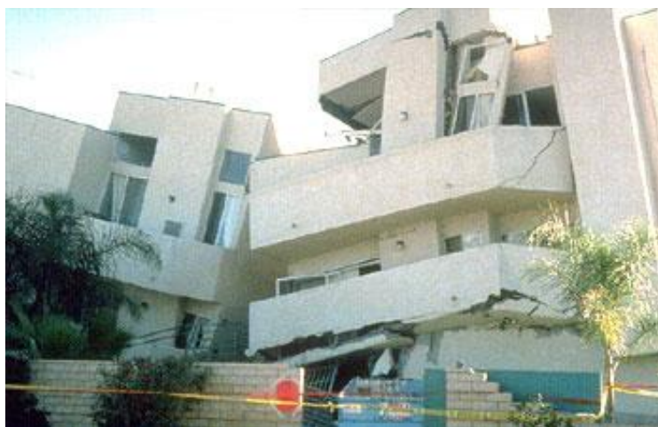
Figura 9. Falla por piso blando en San Fernando Valley (Fuente: Alcorn, 1994)
