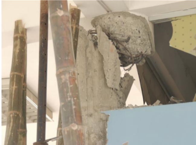
Figura 64. Edificio de Manta, con rótulas plásticas en la cabeza de las columnas del primer piso (GEER, 2016)
