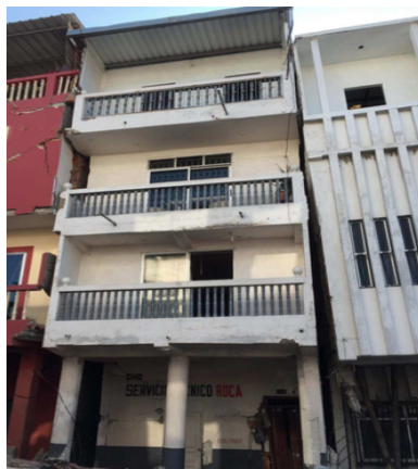
Figura 73. Efecto de golpeteo de edificaciones. (Fuente: GEER, 2016)
