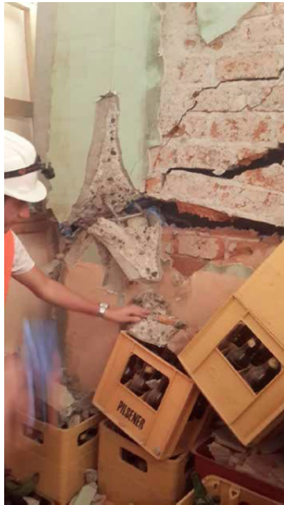
Figura 68. Fisuras diagonales en mampostería post evento sísmico (Dueñas et.al,2016)
