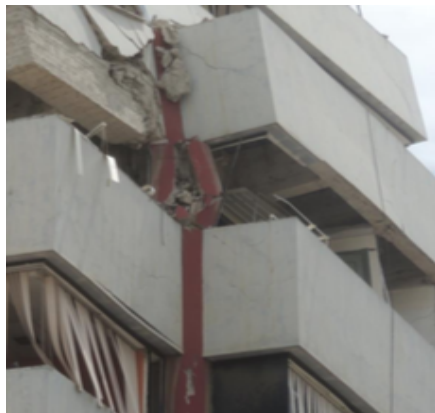
Figura 70. Detalle de falla por columna corta (Fuente: GEER, 2016)
