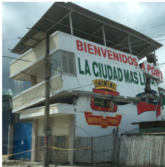
Figura 63. Edificio en Portoviejo colapso por piso blando (GEER, 2016)
