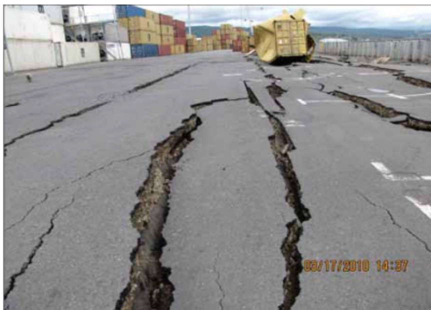
Figura 26. Efecto desprendimiento lateral y licuefacción (Fuente: Emol, 2010)
