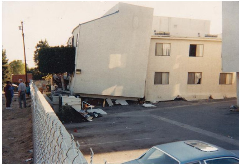
Figura 8. Falla en columnas del primer piso en San Fernando Valley (Fuente: Summer, 2017)
