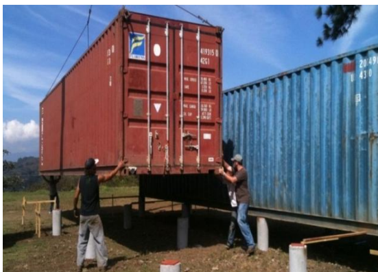
Figura 18: Colocación sobre pilotes, en el lugar designado previo los trabajos de corte
