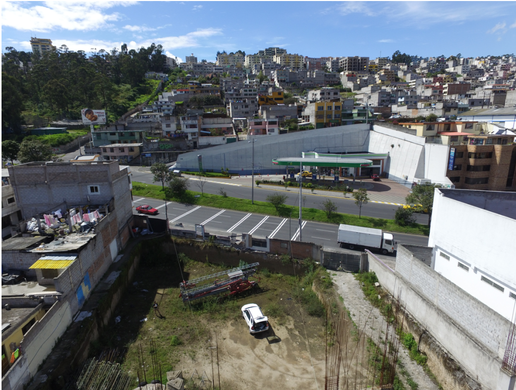
Figura 26. Vista desde el nivel +16.80 hacia el este. Fuente: Investigación de campo. Elaboración propia.
