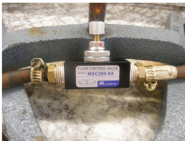
Figura 5.4 Válvula de control de flujo MANDMAN, para regular el caudal de entrada de alimentación
