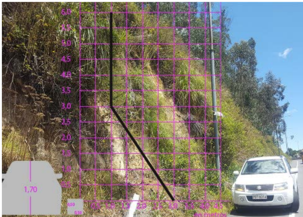
Ilustración 26 Superficie de falla Talud 6
