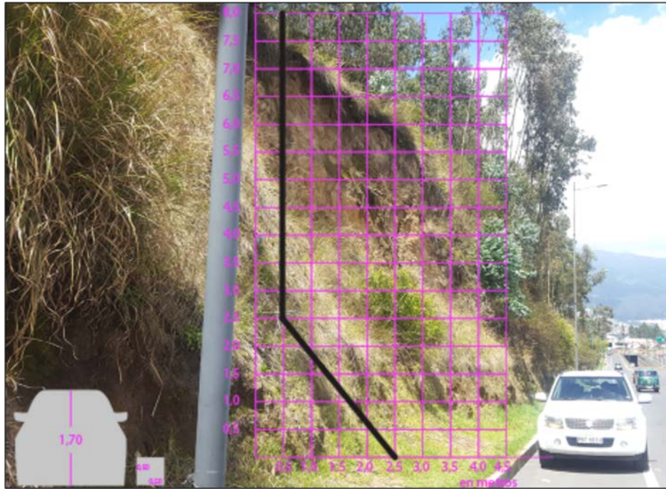
Ilustración 16 Superficie de falla Talud 1
