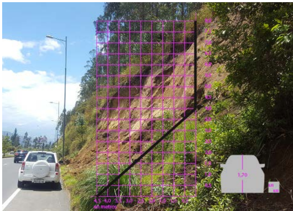
Ilustración 34 Superficie de falla Talud 10
