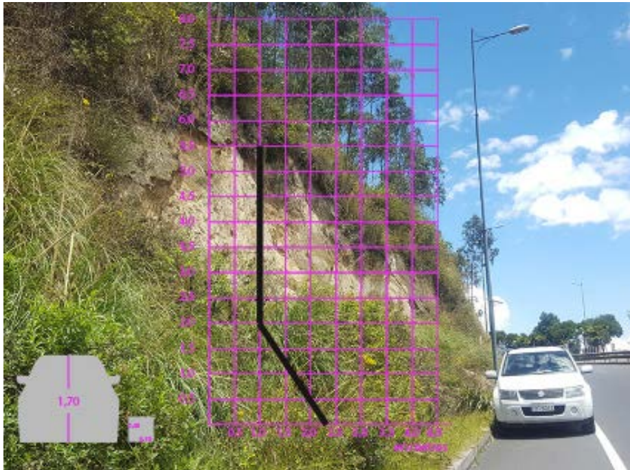
Ilustración 24 Superficie de falla Talud 5
