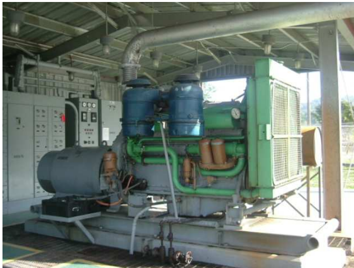
Gráfico 11. Generador del Terminal Marítimo
