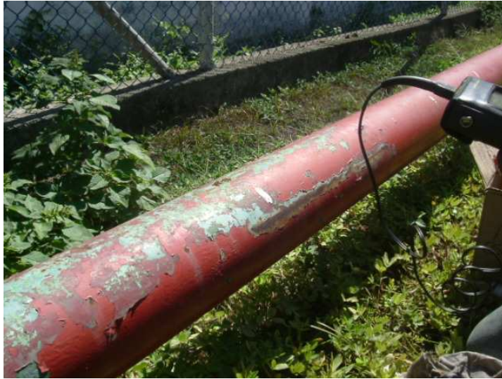
Gráfico 15. Punto #1 (Tubería de 6")
