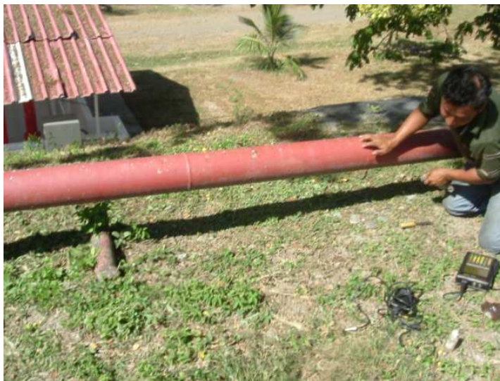
Gráfico 18. Punto #4 (Tubería de 6")
