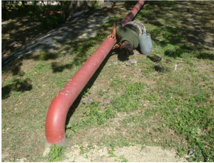
Gráfico 17. Punto #3 (Tubería de 6")
