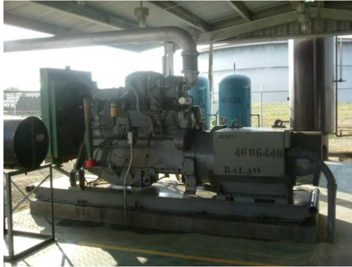
Gráfico 7. Generador del Área de tanques.
