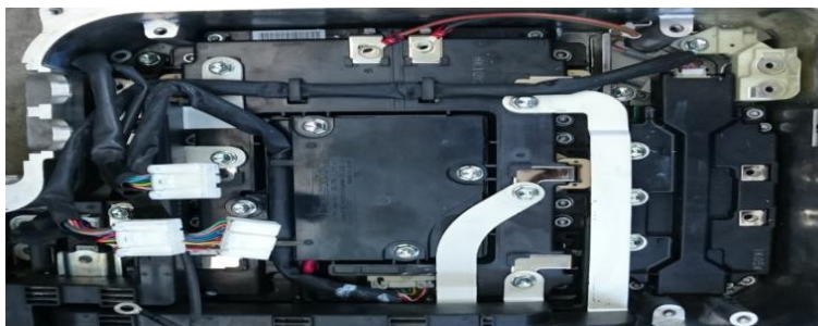
Fotografía 5: Cables de alta tensión Fuente: Autor
