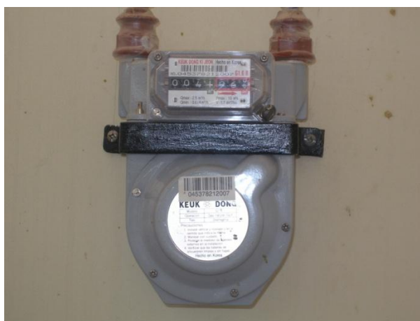
Fig. 3.14. Contador de gas
