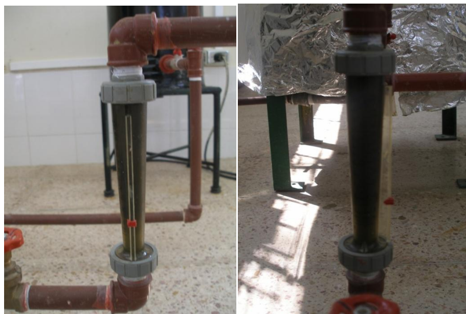
Fig. 3.16. Medidor de caudal
