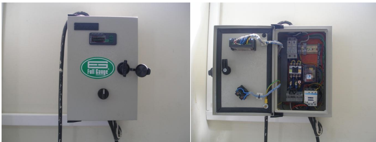
Fig. 3.17. Sistema eléctrico de control automático
