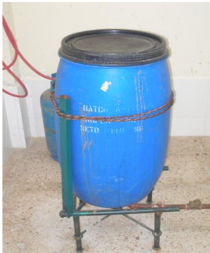
Fig. 3.7. Tanque de mezcla y alimentación
