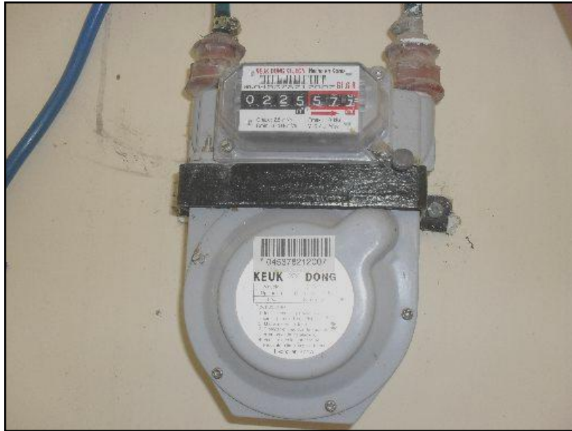
Figura 3.8: Contador de gas
