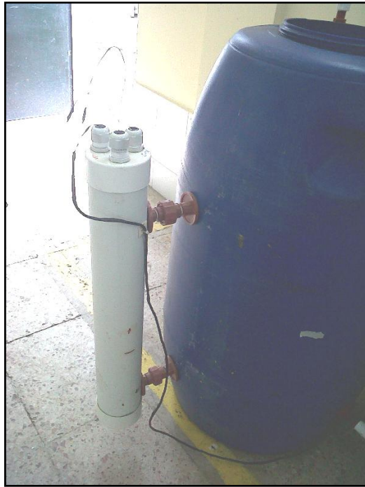
Figura 3.21: Nivel adjunto al tanque # 1 del gasómetro
