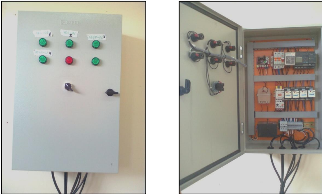
Figura 3.44: Sistema eléctrico de control automático
