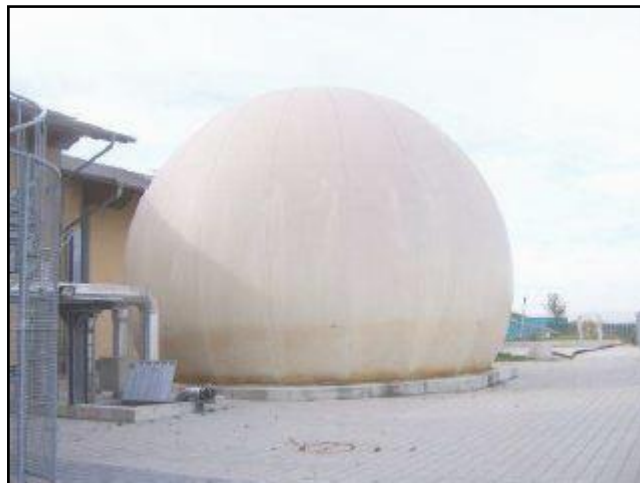
Figura 2.9: Depósito de gas externo de baja presión [12]
