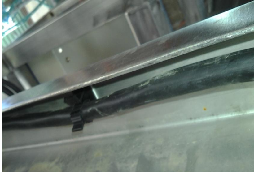
Ilustración 71.- Vinchas para sostener los cables eléctricos
