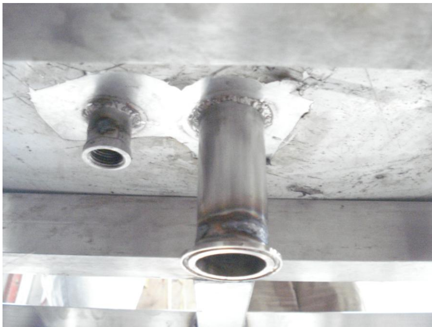
Ilustración 28.- Instalación acople rosca para RTD
