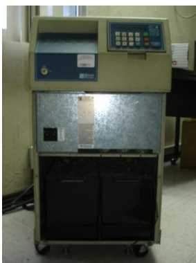
Figura 3.4a: UPS FE4.3KVA (Vista Frontal)
