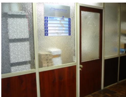
Figura 3.17: Puerta de Ingreso del Cuarto de Equipos del Quinto Piso
