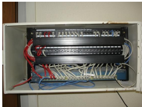
Figura 3.34b: Conmutador Sala de Uso Múltiple
