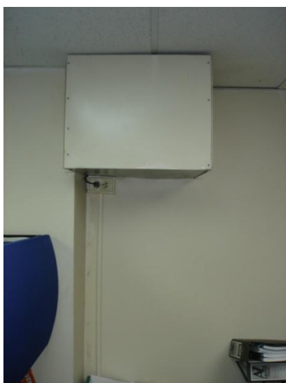
Figura 3.37a: Caja Metálica 2B
