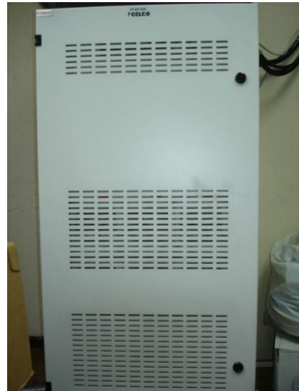
Figura 3.21: Cargador de Baterías
