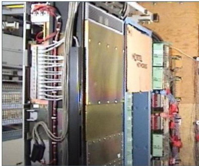
Figura 2.27: Cuarto de Telecomunicaciones
