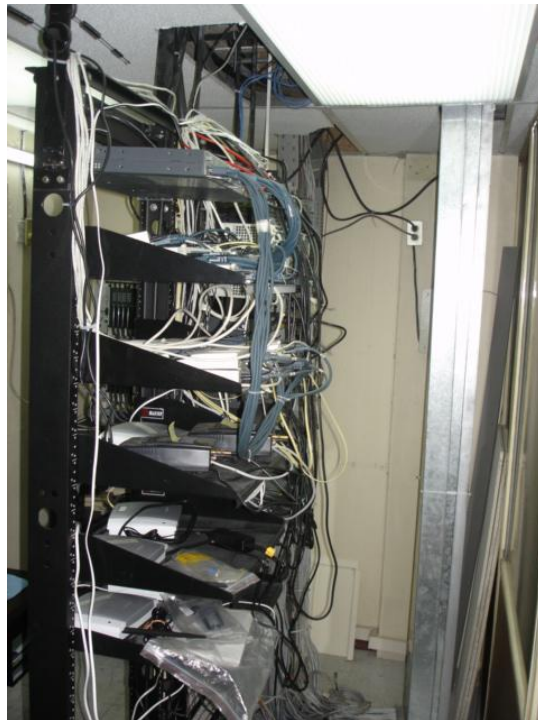
Figura 3.13b: Bastidor del Enrutador, Módems y Bases Celulares (Vista Lateral)
