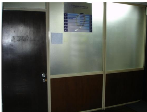
Figura 3.1: Puerta de Ingreso al Cuarto de Telecomunicaciones del Noveno Piso
