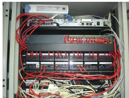
Figura 3.36b: Conmutador Gerencia de Telecomunicaciones
