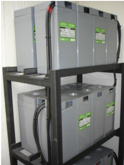
Figura 3.20: Banco de Baterías
