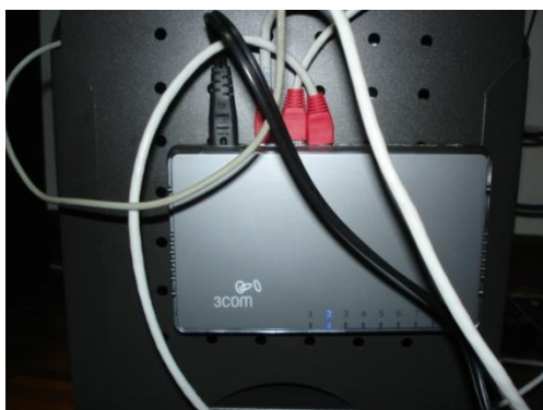
Figura 3.41a: Conmutador Líneas de Transmisión
