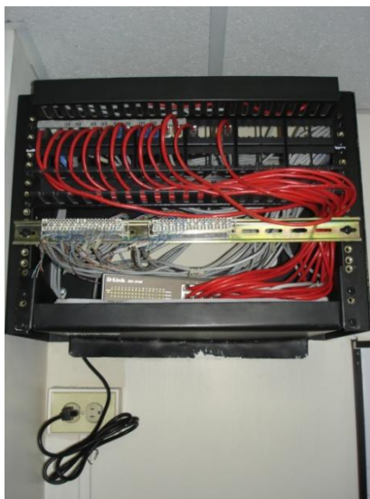
Figura 3.38: Conmutador de la División de Mantenimiento de Líneas de Transmisión
