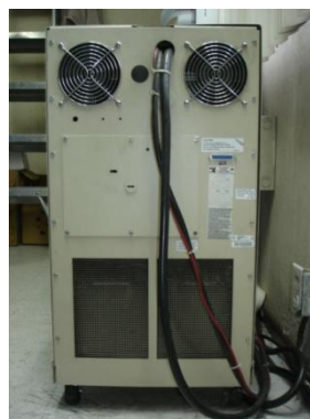
Figura 3.4b: UPS FE4.3KVA (Vista Posterior)
