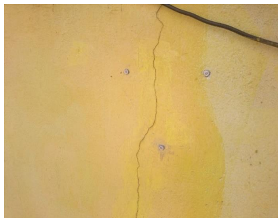
Figura 40. Clavos para control de fisuras mediante terna de puntos
