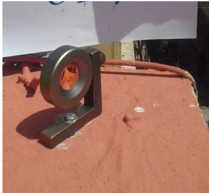
Figura 24. Prisma instalado en superficie
