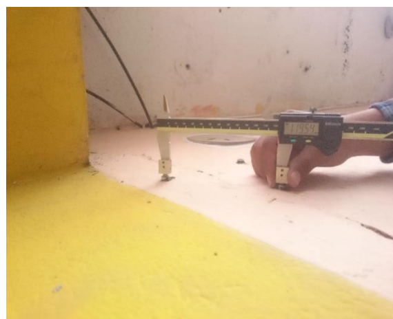
Figura 41. Medición de fisura mediante fisurómetro
