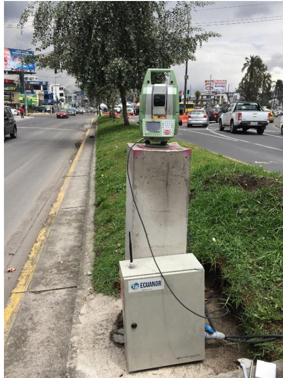
Figura 25. Teodolito automático instalado en superficie
