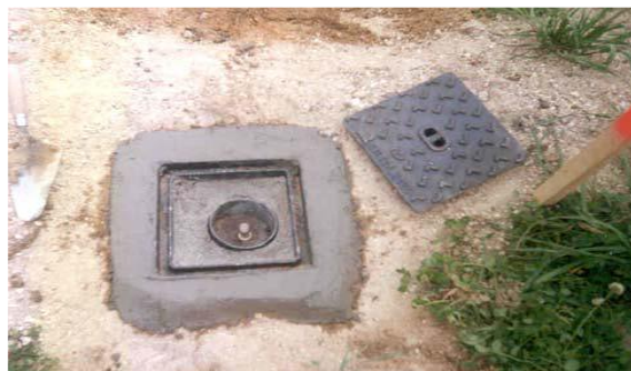
Figura 30. Arqueta de protección para hito de nivelación
