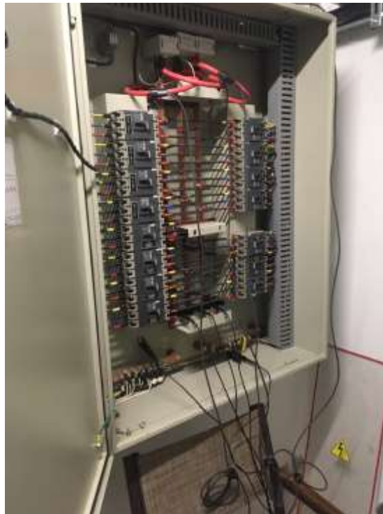
Figura 7. Conexión del Equipo al Tablero de Ascensores y Escaleras
