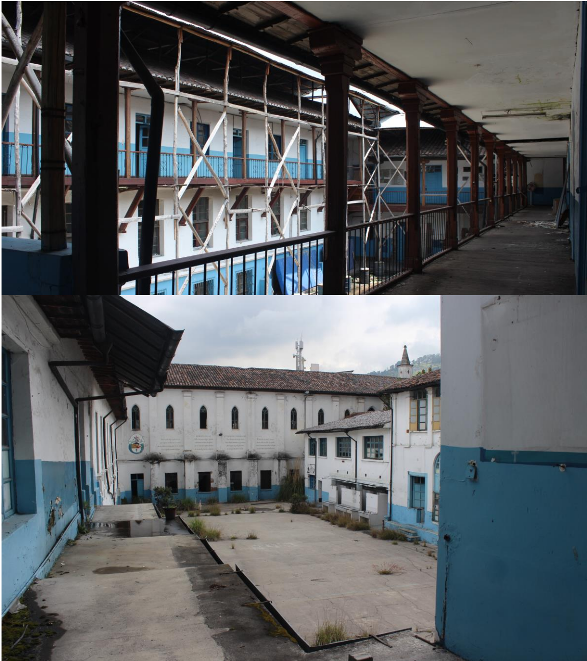
Figura 6: Fotografías del estado actual de las edificaciones
