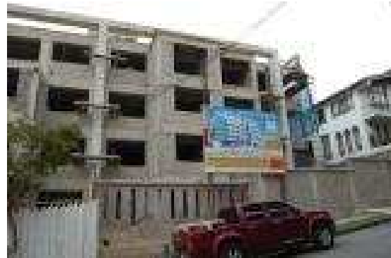
Imagen 3-9: Estado de Edificio Monitor
