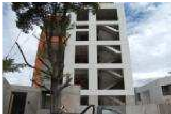
Imagen 3-5: Estado de Edificio Welch
