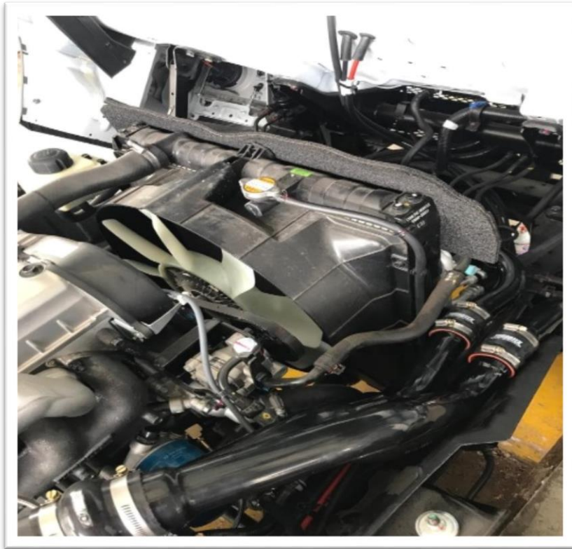
Ilustración 19 Cañerías del sistema de turbo fuente: Elaboracion propia
