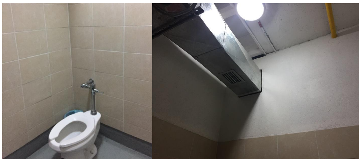
Figura 20 Batería Sanitaria. Fuente: Original.
