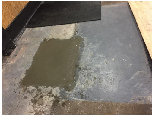
Fotografía 35: Hormigón reforzado con 1% de fibras y w/c = 0.35 vs hormigón tradicional en zonas aledañas
