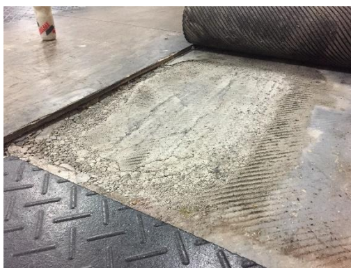
Fotografía 29: Hormigón afectado por el impacto de elementos pesados
