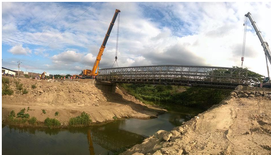
Figura No. 61: Movimiento aguas abajo del viejo Puente sobre el Río Jama
