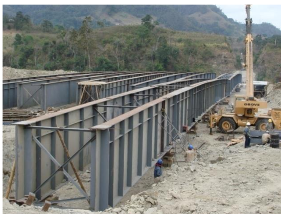
Figura No. 36: Construcción del par de vigas metálicas mediante unión de dovelas
