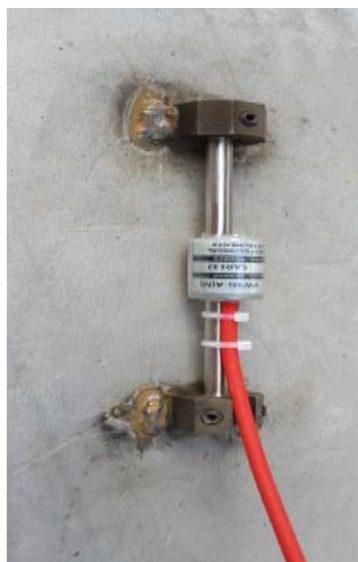
Figura No. 70: Alambre vibratorio BFR instalado en la sección S1
