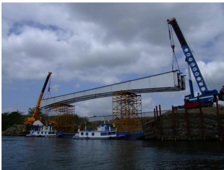
Figura No. 56: Colocación de las vigas metálicas en los pórticos y barcaza
