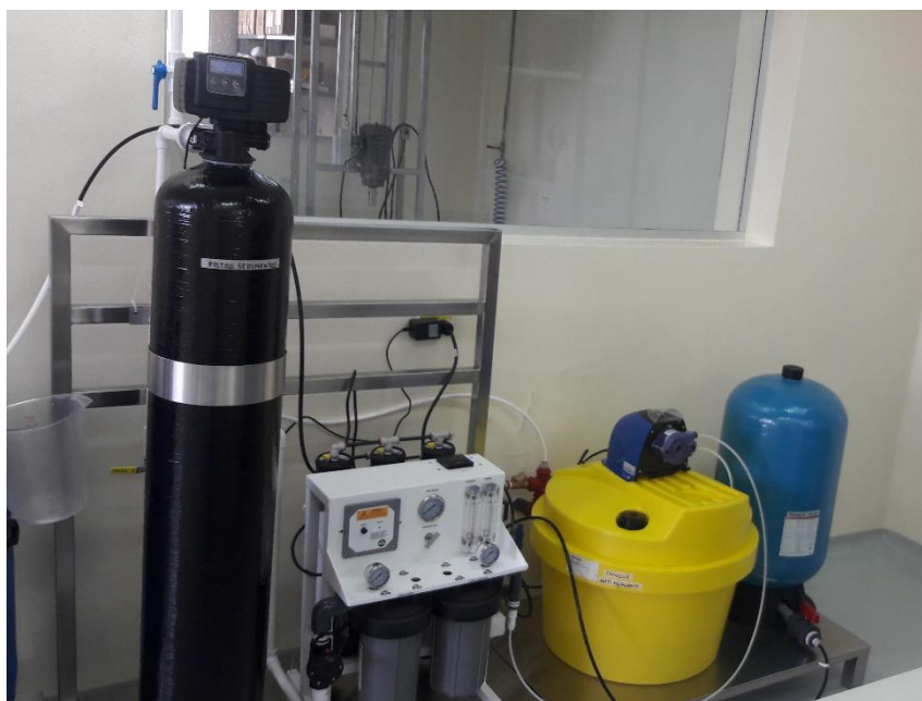
Figura 7. Equipo de tratamiento de agua instalado en la planta de producción de Naturalquimic
