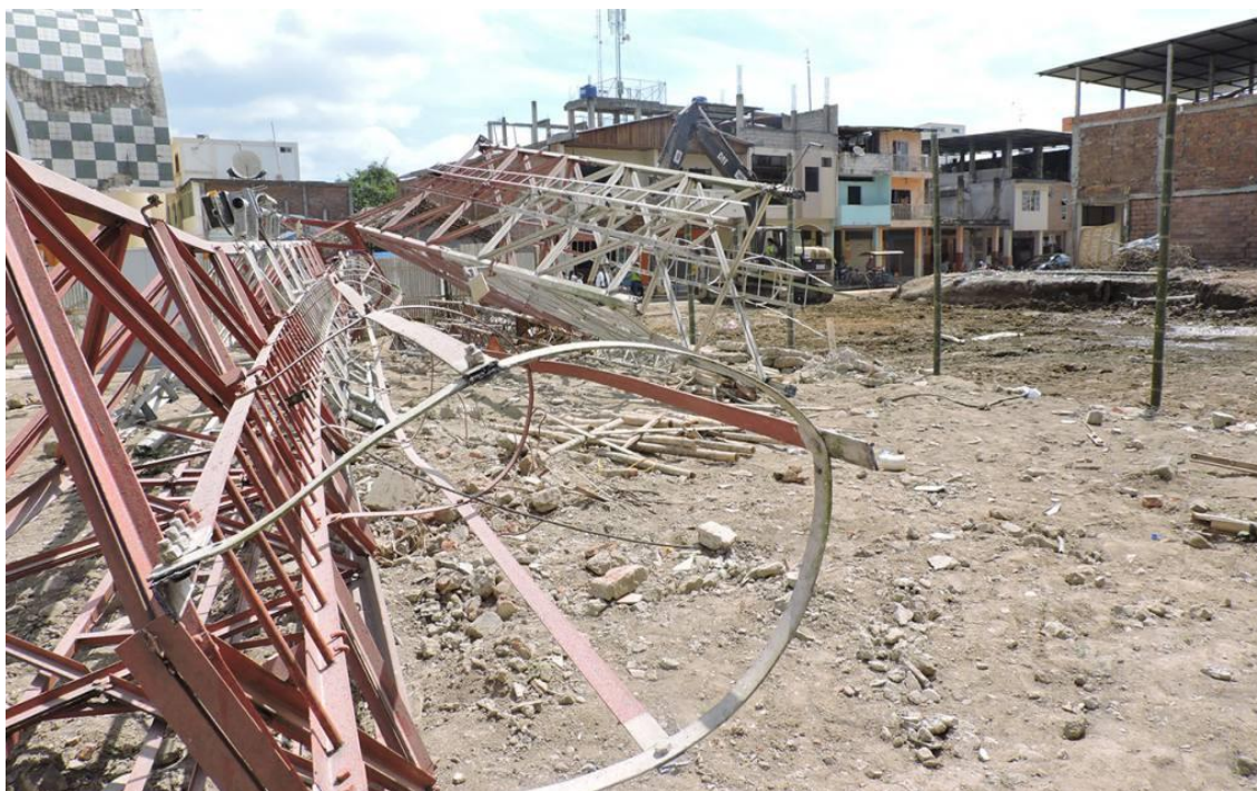
Fotografía 3 Daños en Torres telefónicas Fuente: (Aguirre, 2016)
