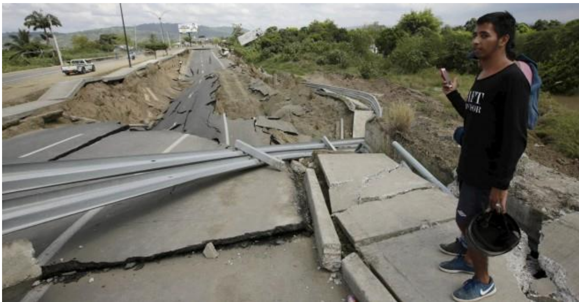
Fotografía 8 Daños en Vías Fuente: (Aguirre, 2016)
