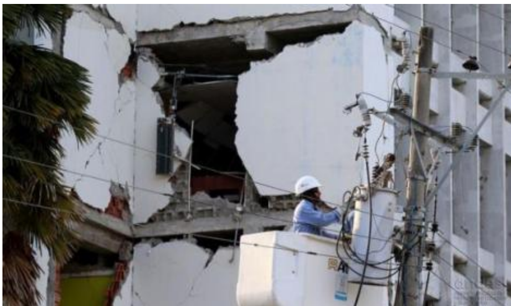
Fotografía 2 Daños en postes eléctricos Fuente (Aguirre, 2016)
