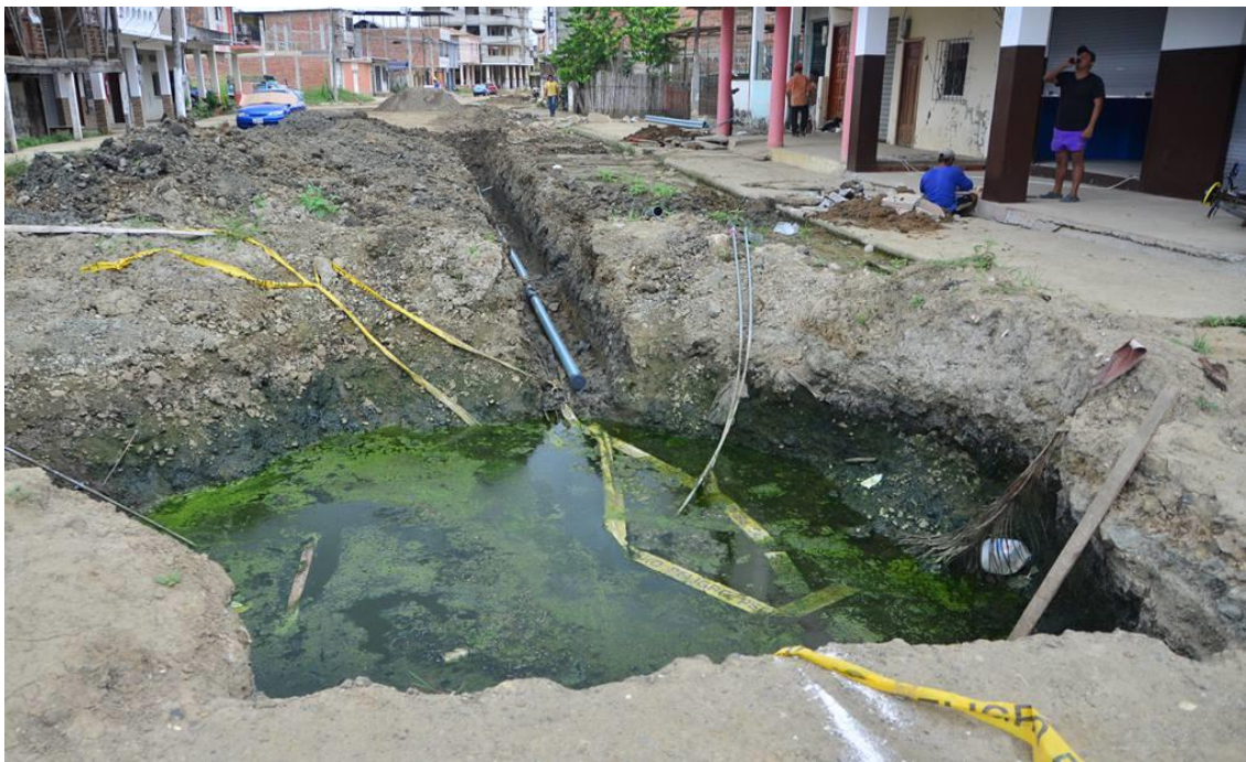
Fotografía 4 Daños en alcantarillado Fuente: (Aguirre, 2016)
