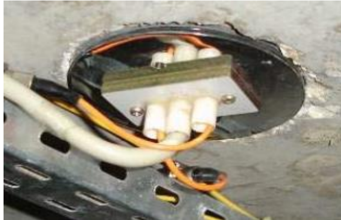
Figura 33: Caja de protección empotrada.
