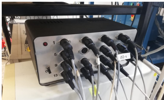
Figura 12. Caja de conexiones.
