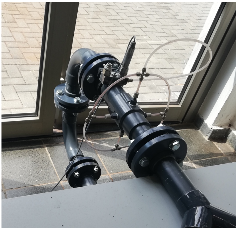
Figura 57. Pieza de tubería para la medición de la presión ensamblada.
