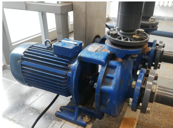
Figura 5. Bomba de la empresa VEB (Bomba 1)
