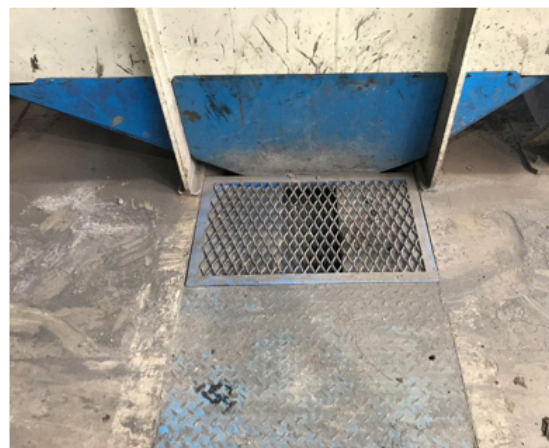
Canal de limpieza calamina regada
