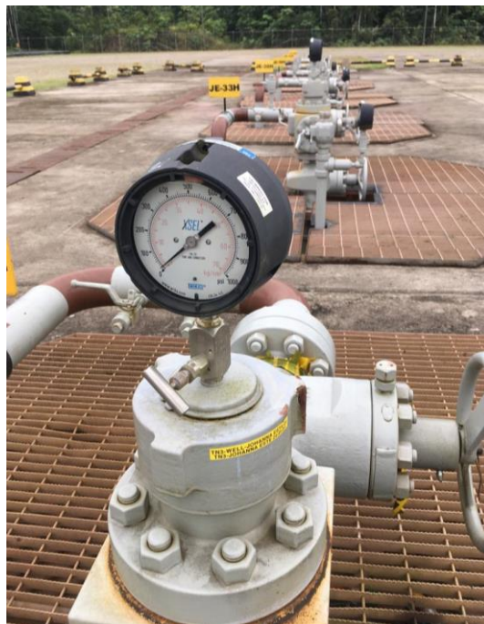
Figura 1. Cabezas de pozo o WELL-HEAD
