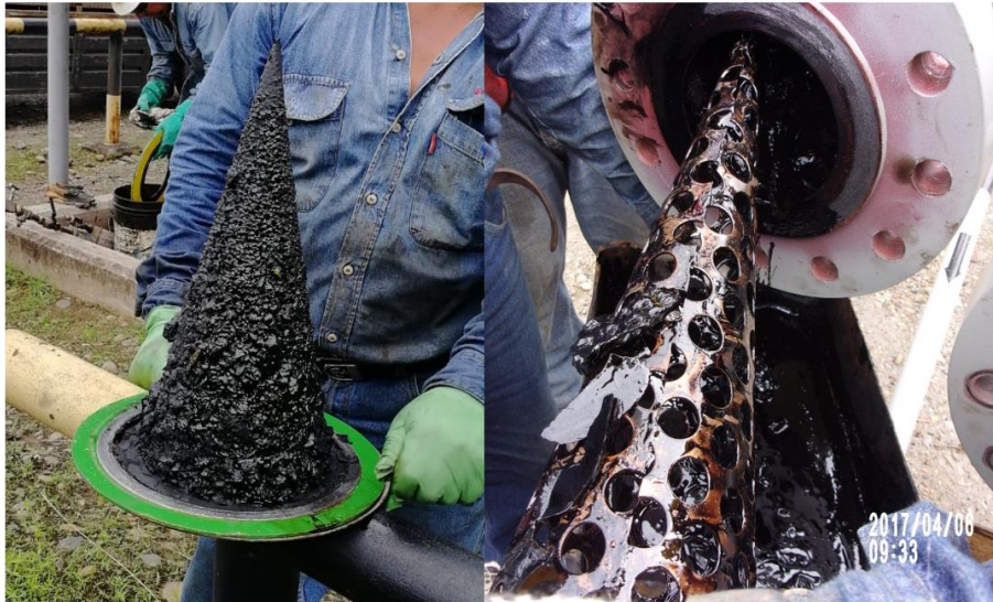
Figura 19. Caso de operación fallida de las MPP. Filtro cono de bruja con obstrucción / Partes de elastómero desprendido (ANDES, 2019)
