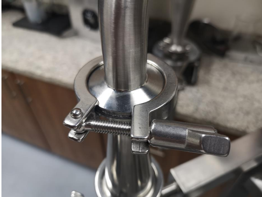
Figura 11. Juntas no permanentes utilizadas (“sanitary clamps”)
