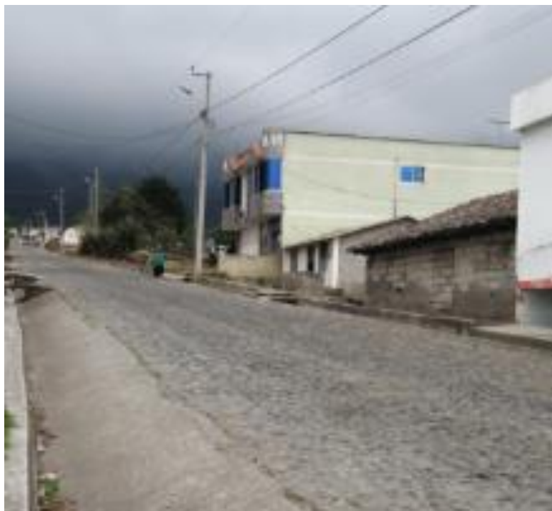
Figura 6. Comunidad de Calpaquí – Estado actual del camino
